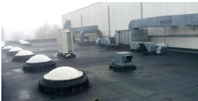
Imagen de climatizadoras en cubierta
