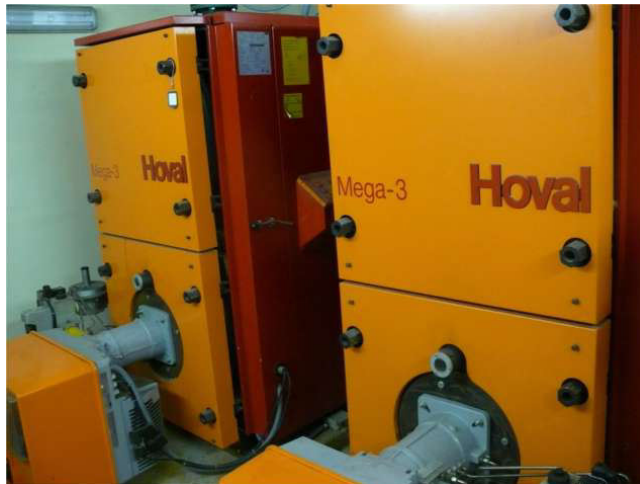
Calderas marca HOVAL modelo MEGA-3
