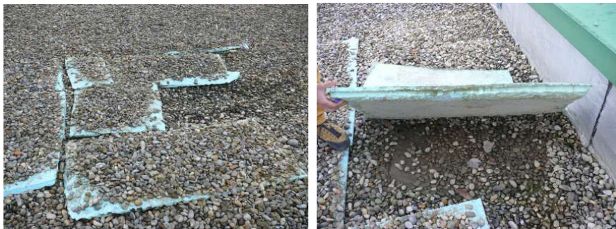
Figura 7: Placas XPS deterioradas
