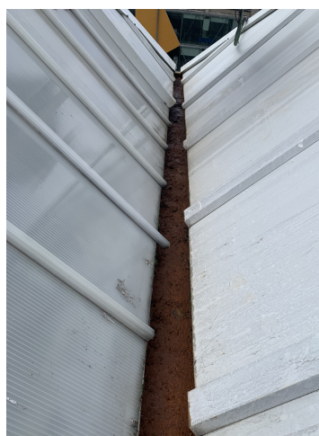
CANALÓN CON ÓXIDO
