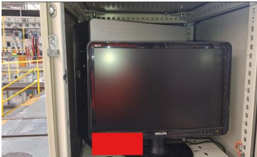
Foto 9. Pantalla y PC actuales en el interior del armario eléctrico.
