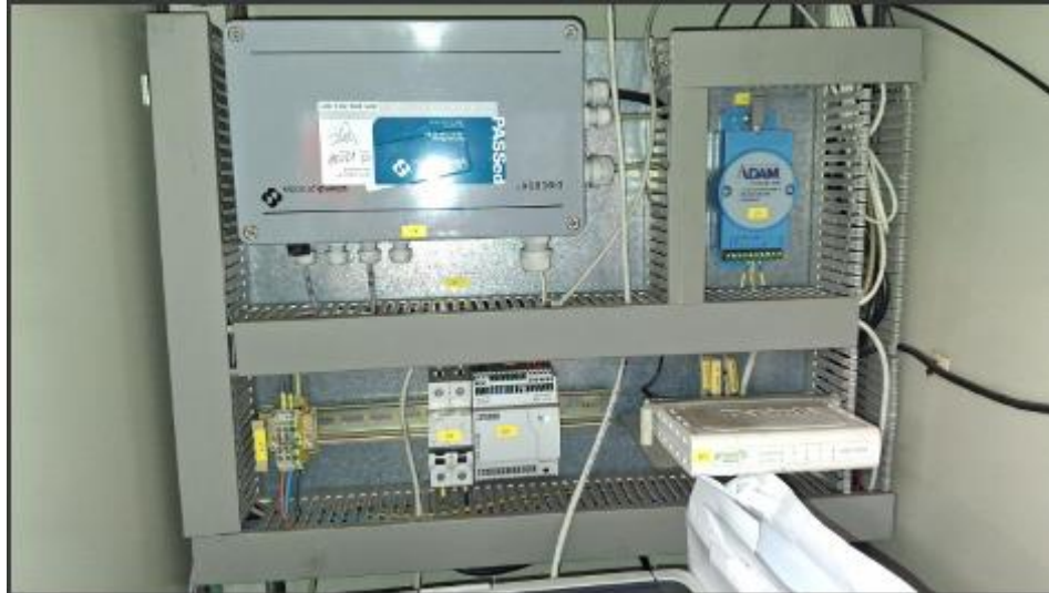
Foto 8. Vista anterior del interior del armario eléctrico con su equipamiento.
