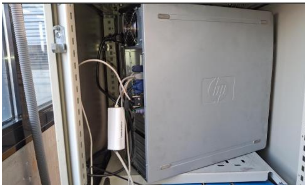
Foto 10. Vista posterior del armario eléctrico y del PC.
