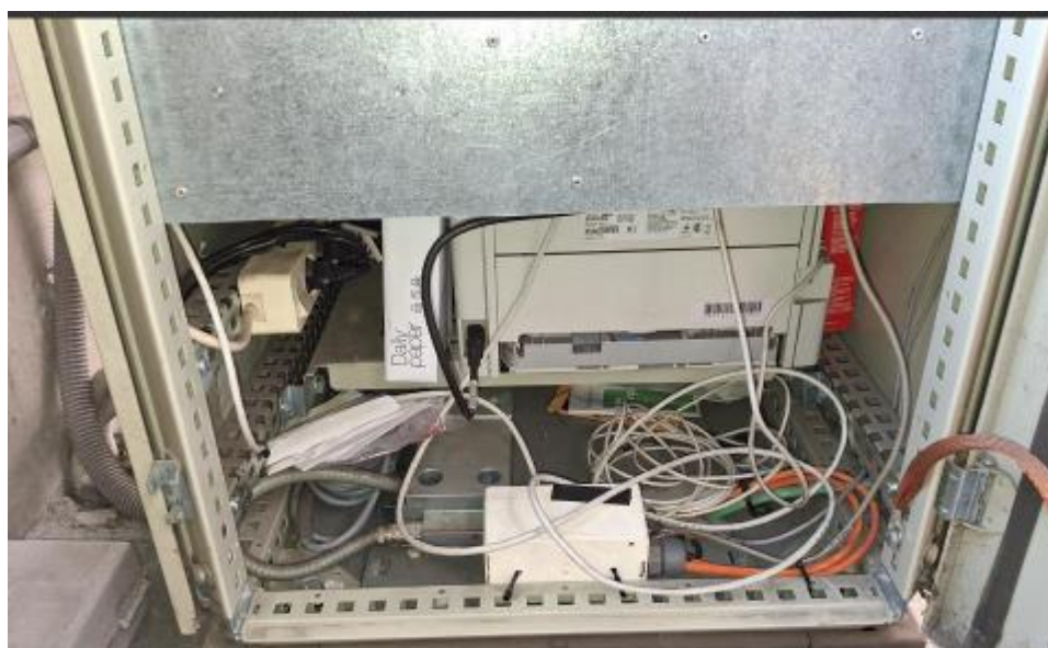
Foto 11. Vista posterior de la parte inferior del armario eléctrico.
