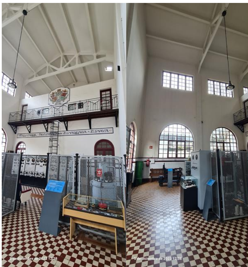
Cabecera de edificación con el centro de transformación
