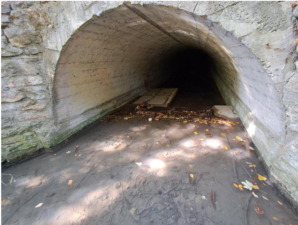
Figura 1 Interior del colector abovedado (3000x1800mm). Obsérvese la solera plana y la presencia de sedimentos y arrastres. Ubicación: PUNTO 1 - RÍO BATÁN
