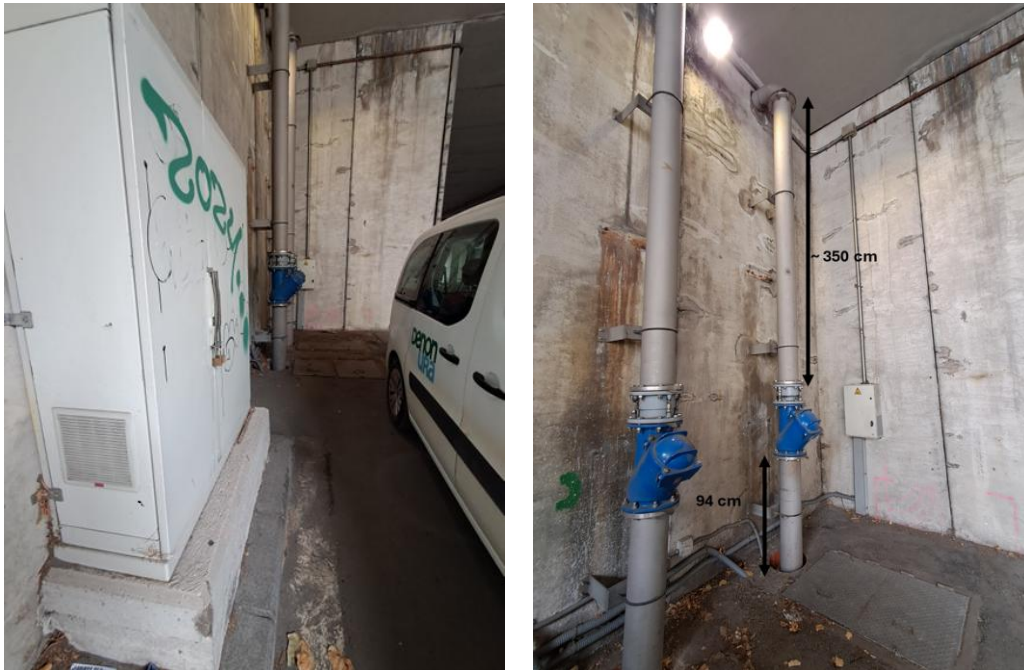
Figura 9 Vistas de la EBAP Zaramaga. (Der): Tramos verticales de impulsión (2x DN200 Acero) a intervenir, aprox. 3.5m de altura. (Izq): Armario eléctrico principal a 5-6m. Ubicación: PUNTO 16 - EBAP ZARAMAGA.
