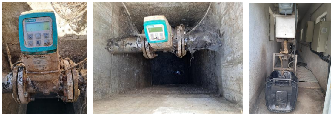
Figura 11 Vistas de la actuación. (Izq./Der.): Detalles del caudalímetro electromagnético DN100 existente y bridas de acero a sustituir en la arqueta. (Centro): Emplazamiento de la arqueta de medición y caseta de control anexa (aprox. 10-15m) para el transmisor remoto. Ubicación: PUNTO 18 - EBAR ASTEGUIETA.
