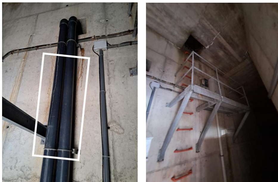
Figura 7 Vistas de la EBAP Fueros. (Izq): Tramos verticales de impulsión (2x DN110 PVC) a intervenir. (Der): Plataforma superior con cuadro eléctrico (aprox. 3m) para instalación de transmisores remotos. Ubicación: PUNTO 14 - EBAP FUEROS BAJO VÍAS.
