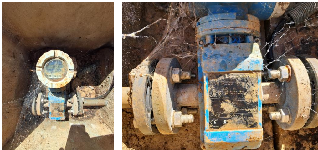
Figura 2 Vistas del caudalímetro bridado existente (DN25 PN40) a sustituir en la arqueta. Ubicación: PUNTO 9 - EDAR ARANGUIZ.
