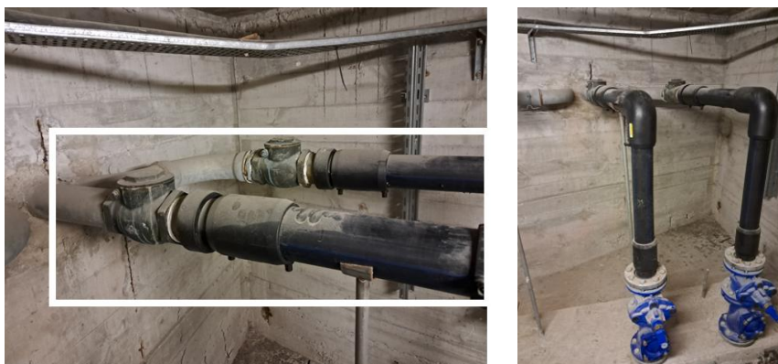
Figura 8 Vistas de la EBAP Fueros (Horizontal). (Izq): Vista general de las dos tuberías horizontales (DN90 PVC). (Der): Detalle de la zona de instalación, aguas arriba de las válvulas de retención. Ubicación: PUNTO 15 - EBAP FUEROS.
