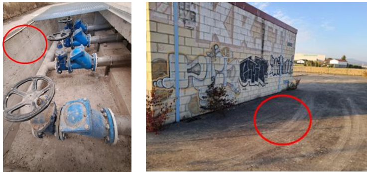
Figura 4 Vistas de la EBAP DN150. (Izq): Arqueta interior de válvulas, sin espacio para caudalímetro. (Der): Zona exterior (círculo rojo) propuesta para la ejecución de la nueva arqueta de medición (a ejecutar por un tercero). Ubicación: PUNTO 11 - EBAP JUNDIZ (DN150).
