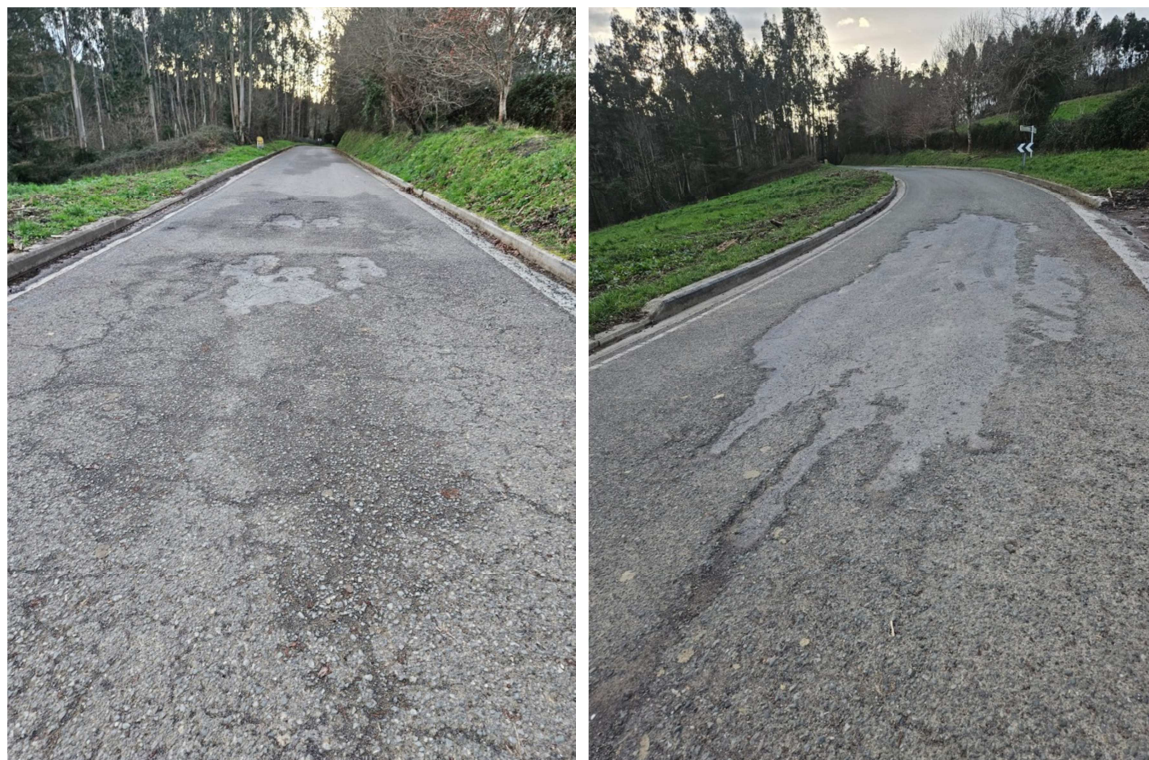
Fotografías: Vistas del estado actual del asfalto a lo largo del vial.
