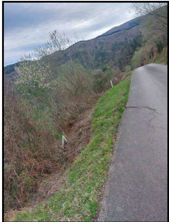
Imagen 4: Deslizamiento del talud de sustentación
