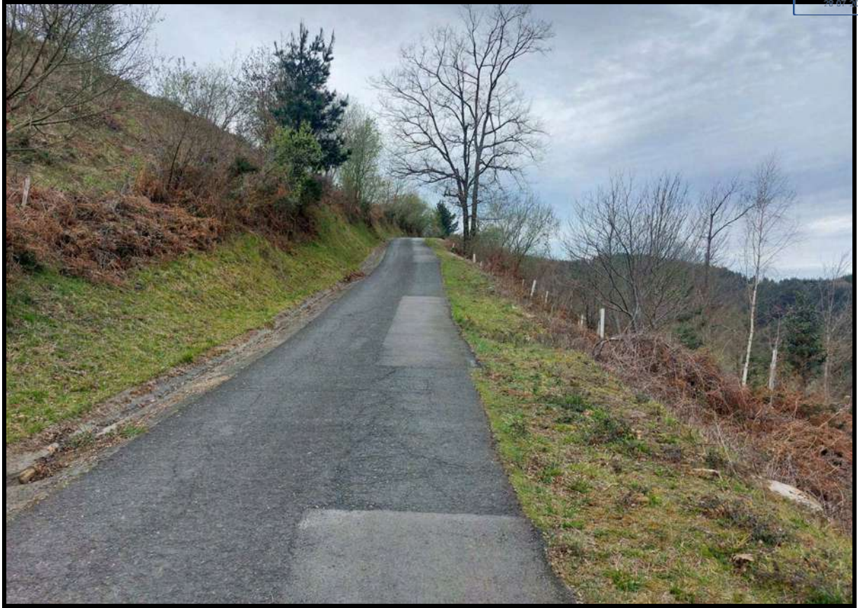
Imagen 1: Vista de tramo con actuaciones de parcheo del pavimento
