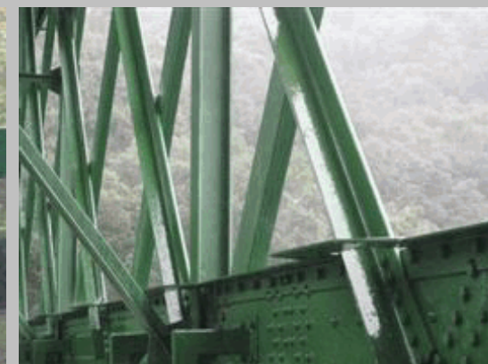
2011 98 Agua de lluvia deslizando por diagonales
