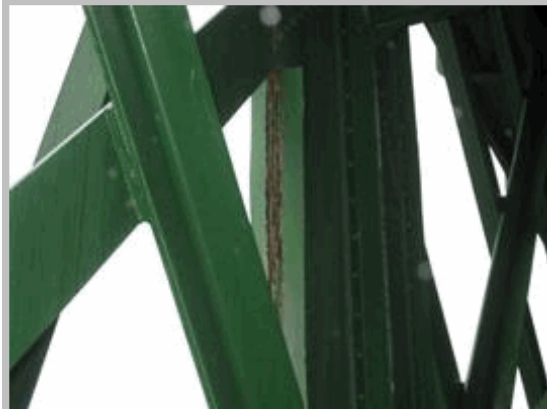
2011 15 Detalle de oxidación en montante lado derecho vano 1
