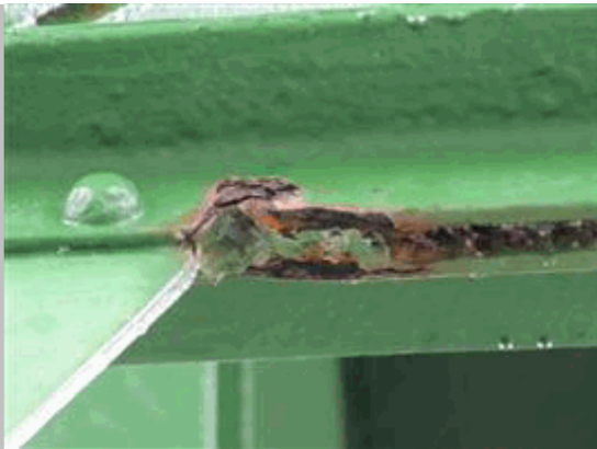
2011 116 Detalle corrosión en barra transversal de diafragma en vano 2
