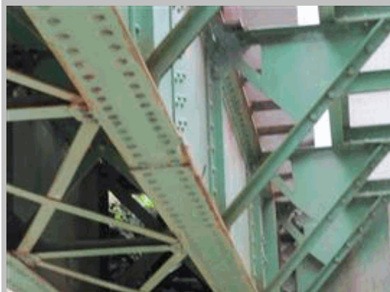
2011 80 Corrosión en ala inferior de viga izquierda del vano 3
