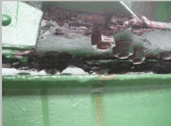
2011 60 Detalle de corrosión de cordón inferior izquierdo con pérdida de sección en unión vano 1
