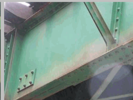
2011 83 Pátina de óxido en alma de viga derecha del vano 3, próxima a pila 2
