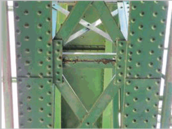
2011 24 Detalle de corrosión en marcos de arriostramiento vertical en centro de luz, en vano 1
