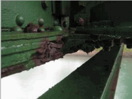
2011 06 Detalle oxidación en cordón inferior derecho próximo a pila 1 vano 1
