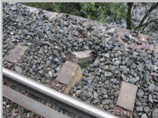
2011 125 Rotura de imposta de sillera en muro en vuelta izquierdo del estribo 1
