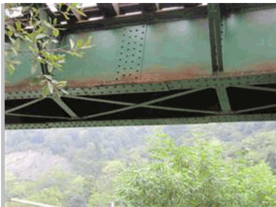
2011 85 Pátina de óxido en alma y deformación de ala inferior de la viga izquierda del vano 3
