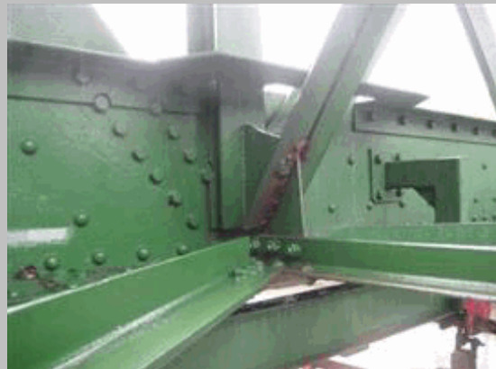
2011 33 Diagonal de diafragma transversal oxidado en unión con cartela de nudo con cordón inferior derecho vano 1
