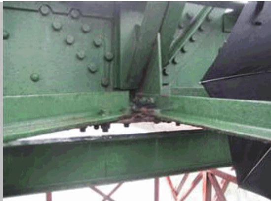
2011 55 Corrosión en nudo con cordón inferior derecho vano 1
