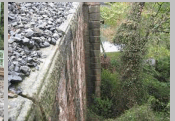
2011 174 Vista de muro en vuelta lado derecho estribo 1 con humedades
