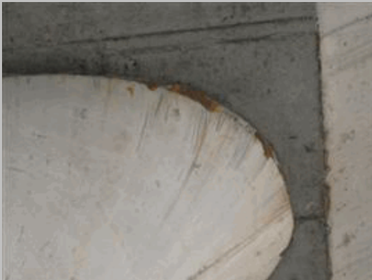
2011 36 Pátina de óxido en lado izq pila 2
