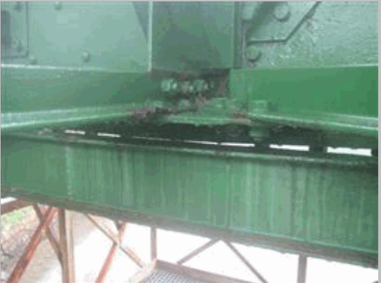
2011 77 Corrosión en nudo de cordón inferior izquierdo vano 1
