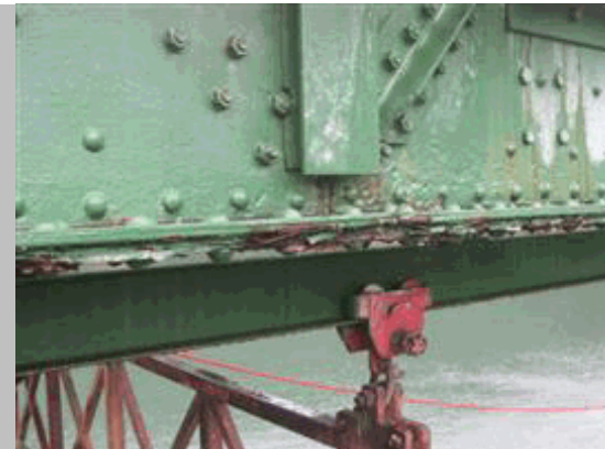
2011 58 Cordón inferior izquierdo con corrosión y pérdida de sección en vano 1
