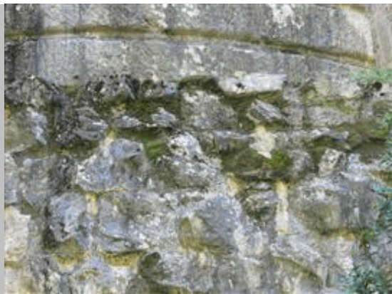
2011 10 Pátina biológica en cimentación de estribo 1
