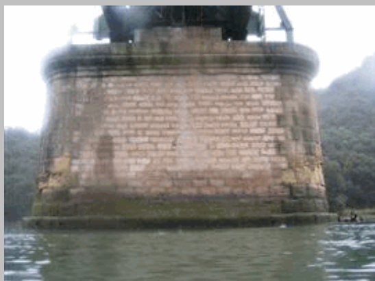
2011 200 Alzado pila 1 lado vano 1 con humedades
