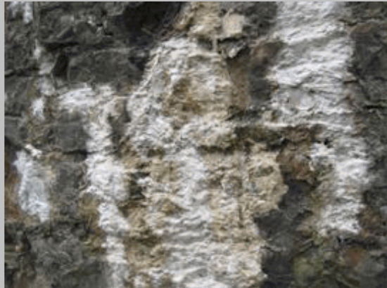
2011 180 Costra calcárea en muro en vuelta lado izquierdo estribo 1
