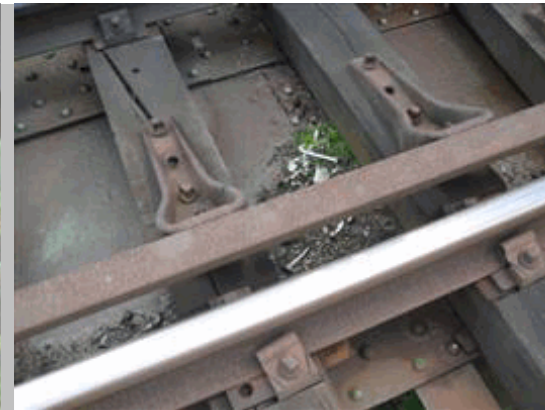
2011 117 Acumulación de escombros sobre chapa superior, próximo a estribo 1
