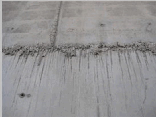
2011 47 Detalle de coqueras pila 2 lado vano 2
