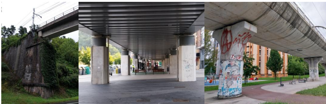
Viaductos sin acceso a revisión de aparatos de apoyo.
