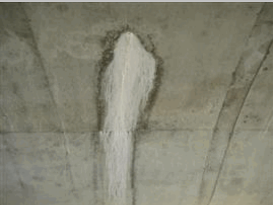
2011 09 Costra calcárea en lado izq vano 17
