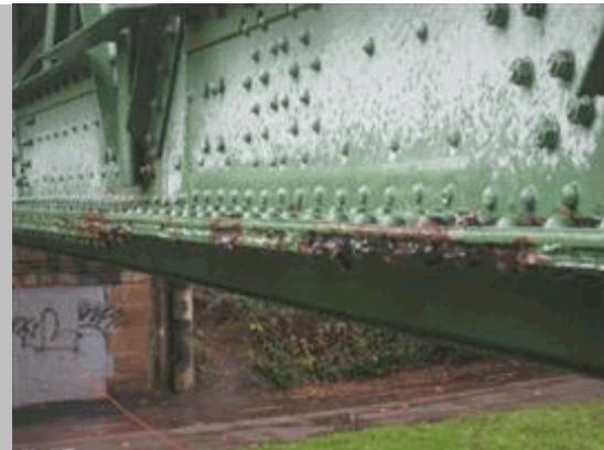
2011 57 Cordón inferior derecho con corrosión y pérdida de sección en vano 1
