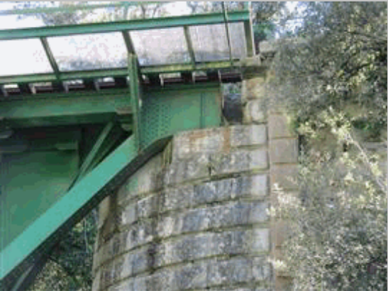
2011 09 Visata de cargadero en estribo 1, con humedades
