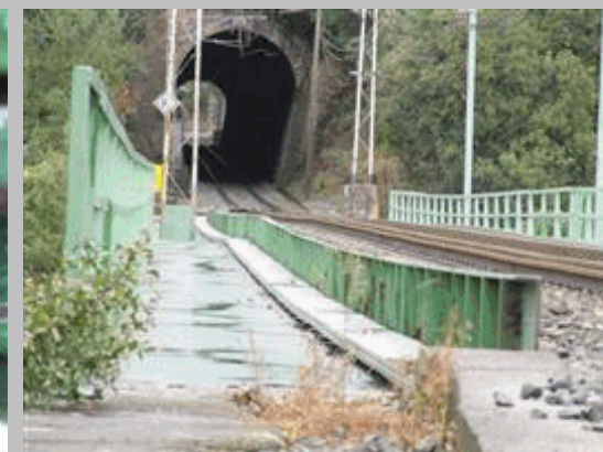
2011 173 Deformación puente vista desde estribo 1 lado izquierdo
