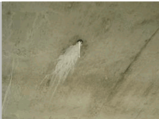
2011 10 Costra calcárea en lado izq vano 17
