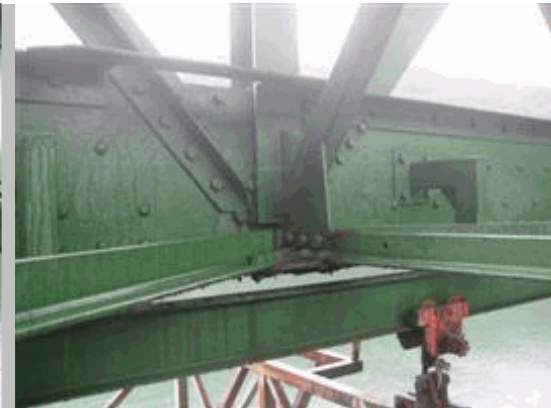
2011 59 Unión con cordón inferior izquierdo con corrosión
