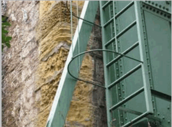
2011 184 Arenización en sillería en lado derecho estribo 1
