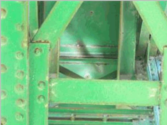
2011 36 Detalle de corrosión en chapa superior en vano 1
