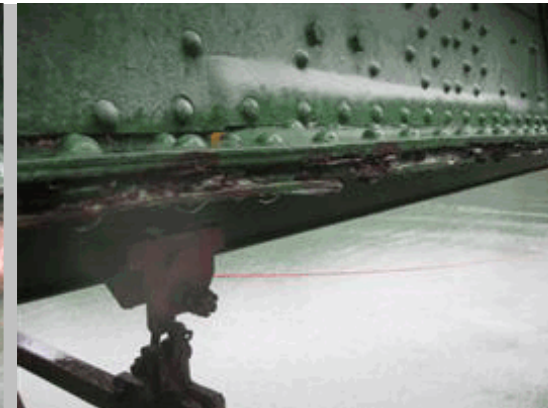
2011 87 Detalle cordón inferior derecho con corrosión y pérdida de sección vano 1
