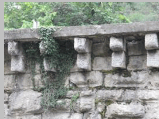
2011 97 Vegetación enaizada en muro en vuelta derecho del estribo 2
