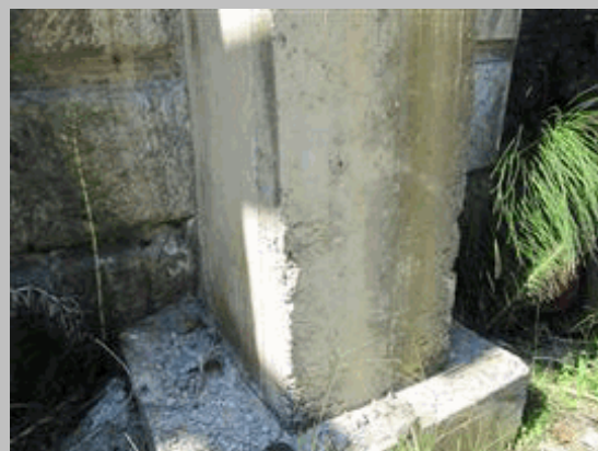
2011 96 Coqueras en el hormigón del constrafuerte, en el lado derecho del estribo 2
