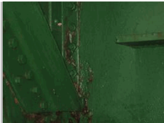
2011 10 Detalle de oxidación con pérdida de sección en cartela de nudo sobre apoyo izquierdo pila 1 vano 1
