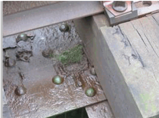
2011 115 Corrosión y pátina biológica en cordón superior derecho del vano 1
