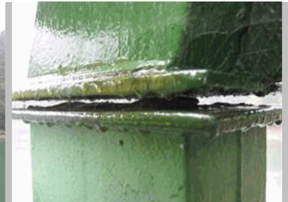
2011 89 Estabilizador lado izquierdo pila 1 sin chapa de continuidad
