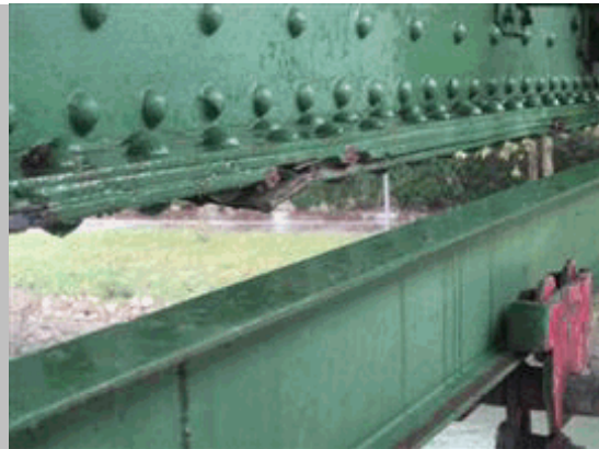
2011 43 Detalle de corrosión de unión de pletinas
