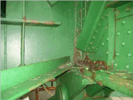
2011 07 Detalle de oxidación en nudo sobre apoyo derecho en pila 1 vano 1
