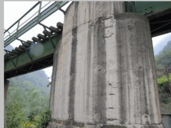
2011 61 Humedades y armadura pasiva corroida en el cargadero de la pila 2, en el lado derecho
