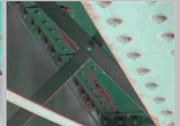
2011 79 Corrosión de unión de ala superior de viga derecha de vano 3 con chapa superior
