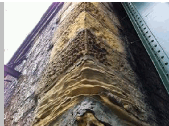
2011 207 Alveolización de sillares en E-1 derecho
