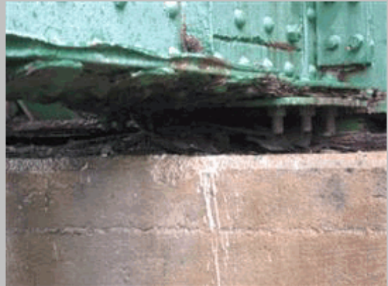
2011 124 Detalle de corrosión en cordón inferior izquierdo en apoyo en apoyo estribo 2 con pérdida de sección
