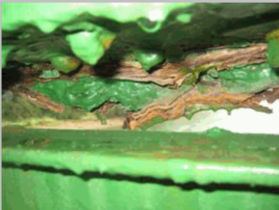
2011 111 Detalle de corrosión y pérdida de sección en cordón inferior derecho vano 2
