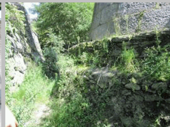
2011 52 Vegetación enraizada abundante en pila 1 en el lado vano 2
