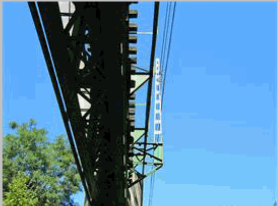
2011 39 Unión de soporte de catenaria a celosía mediante voladizo
