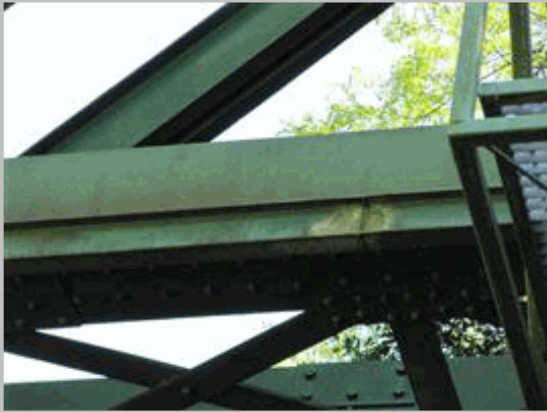
2011 21 Pátina de óxido en cordón inferior izquierdo, próximo a estribo 1
