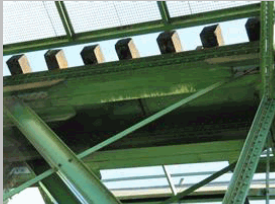
2011 35 Detalle de descascarillamiento en cordón superior izquierdo del vano 1, en centro de luz
