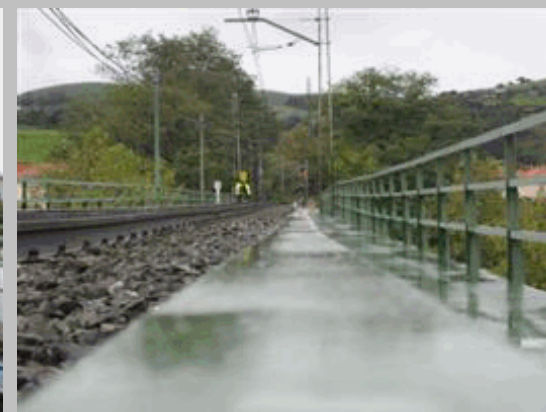
2011 158 Deformación puente vista desde estribo 2 lado izquierdo
