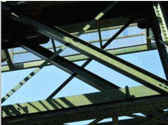
2011 27 Detalle de comienzo de pátina de óxido en diagonales y cordón inferior del lado derecho, en vano 1
