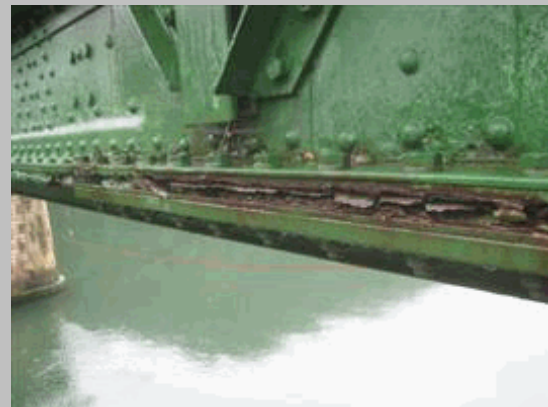
2011 67 Detalle de cordón inferior izquierdo con corrosión y pérdida de sección en zona de máximo momento positivo vano 1
