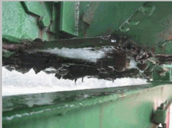
2011 61 Detalle de corrosión de cordón inferior izquierdo con pérdida de sección en unión vano 1
