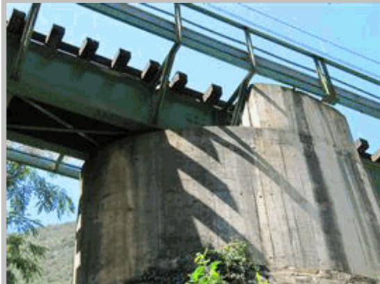
2011 60 Vista cargadero de pila 2 desde lado derecho con humedades
