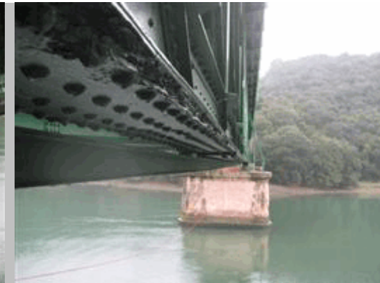
2011 88 Vista inferior cordón inferior derecho con corrosión y pérdida de sección vano 1 próximo a estribo 1
