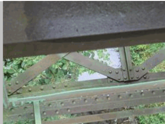
2011 116 Deformación del alma del cordón inferior izquierdo del vano 1, próximo a la pila 1
