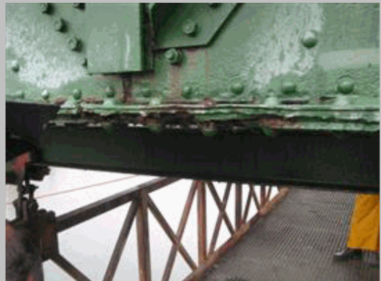
2011 34 Cordón inferior lado derecho vano 1 con corrosión y pérdida de sección
