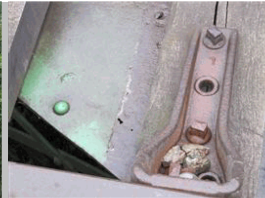
2011 102 Perforación por corrosión en chapa superior del vano 3 sobre estribo 2
