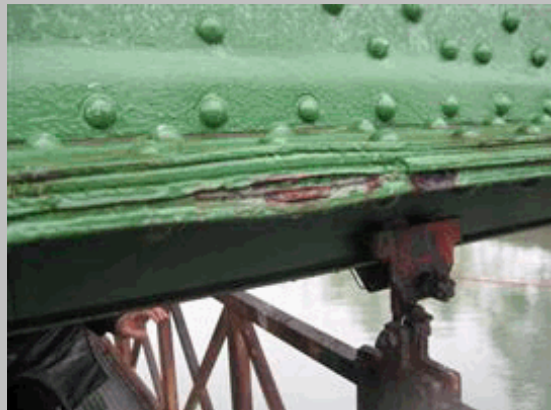
2011 32 Cordón inferiro derecho con oxidación y aumento de volumen
