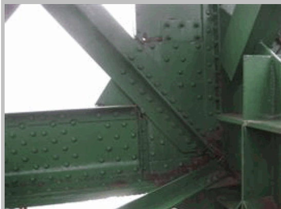
2011 95 Cartela unión cordón inferior derecho vano 2 con corrosión y pérdida de sección
