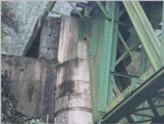
2011 16 Humedades en el lado derecho del cargadero en estribo 1
