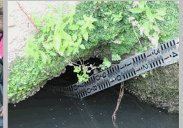
2011 49 Profundidad aproximada de la socavación de pila 1
