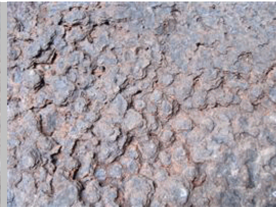
2011 192 Detalle de pletina de acero corroida
