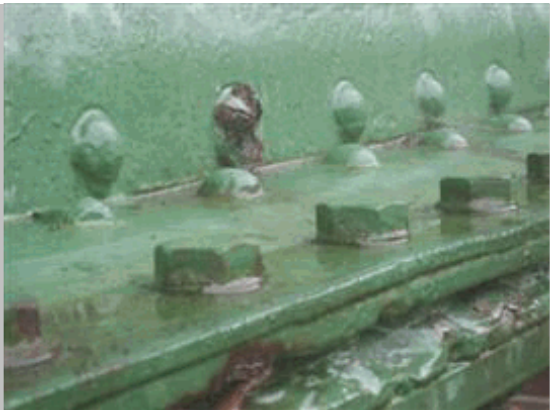
2011 71 Pérdida de bulón por corrosión en cordón inferior izquierdo zona de máximo momento positivo en vano 1
