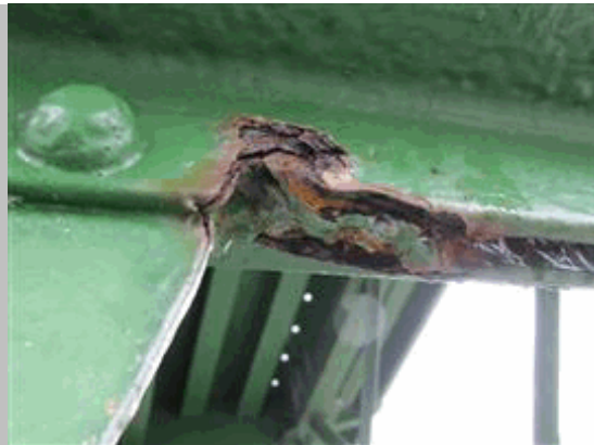
2011 117 Detalle corrosión en barra transversal de diafragma en vano 2
