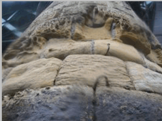
2011 195 Detalle de pérdida de sillar en pila 1 , tajamar aguas arriba
