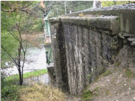
2011 176 Muro en vuelta lado izquierdo estribo 1 con humedades
