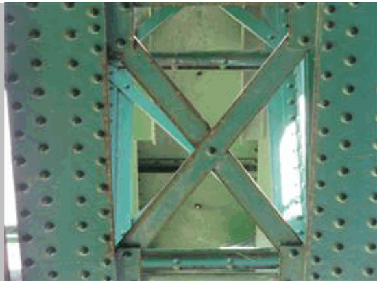
2011 25 Detalle de pátina de óxido en arriostramiento contraviento en centro de luz, en vano1
