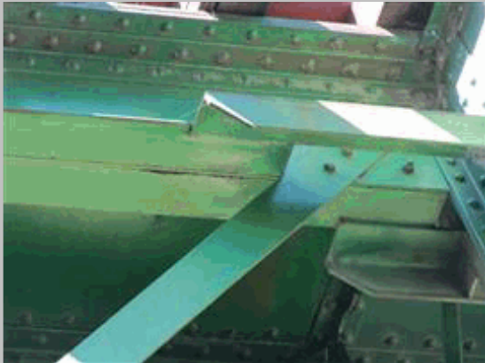
2011 31 Detalle de oxidación en unión ala-alma del cordón superior del lado izquierdo, en vano 1
