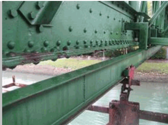
2011 42 Corrosión en unión de pletinas en cordón inferior derecho vano 1 visto desde dentro de cercha
