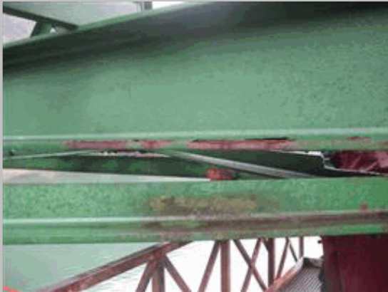
2011 46 Corrosión en cordón inferior de la cercha central vano 1
