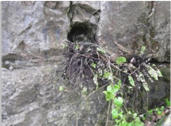
2011 179 Vegetación enraizada en muro en vuelta lado izquierdo estribo 1
