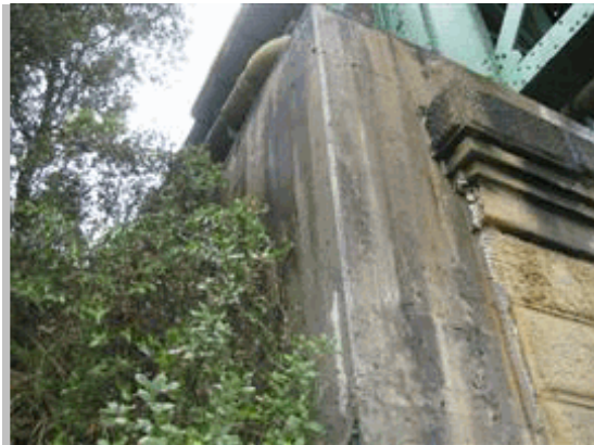
2011 145 Vista muro en vuelta izquierdo estribo 2 con abundante vegetación
