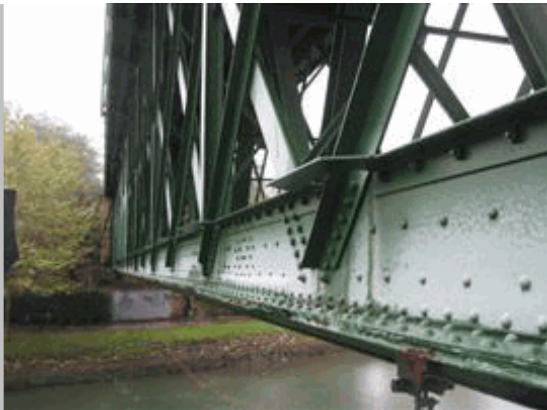
2011 26 Vista lado derecho con oxidación continuada del cordón inferior en vano 1
