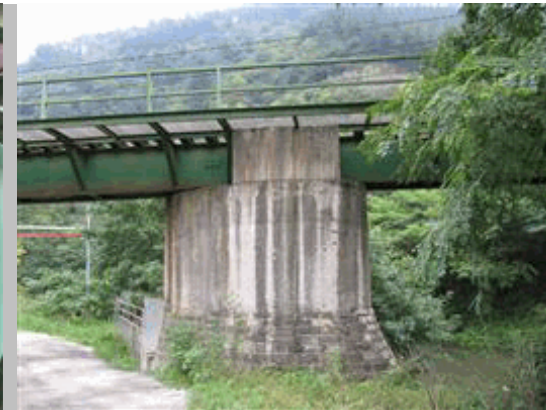
2011 73 Vista pila 2 desde lado izquierdo con humedades
