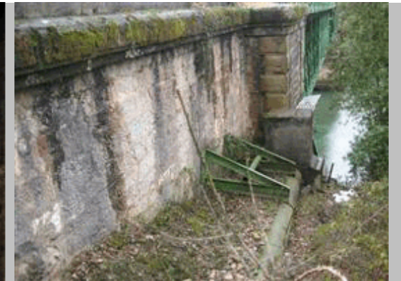
2011 149 Muro en vuelta lado izquierdo con humedades y pátinas biológicas
