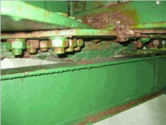
2011 04 Detalle oxidación en cordón infeior derecho próximo a pila q vano 1
