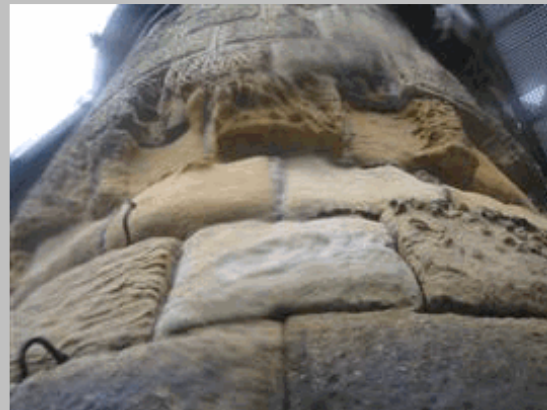
2011 196 Detalle de pérdida de sillar en pila 1 , tajamar aguas arriba
