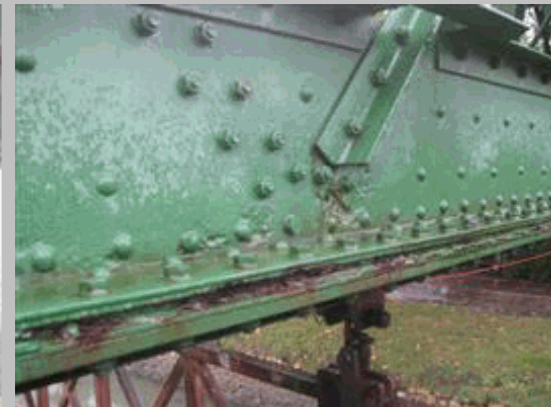
2011 64 Corrosión en cordón inferior izquierdo vano 1 con pérdida de sección en zona de máximo momento positivo
