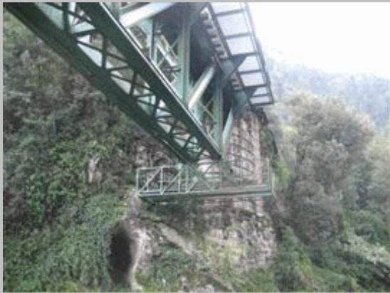
2011 17 Vista estribo 1 con socavón en roca próxima
