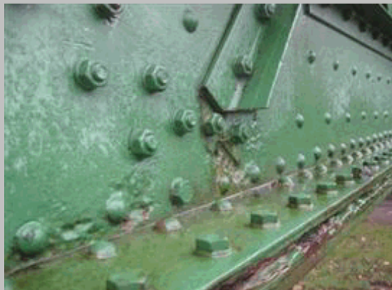
2011 65 Corrosión de alma de cordón inferior pintada en zona de máximo momento positivo vano 1
