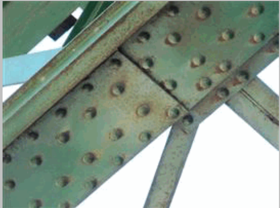
2011 34 Detalle de pátina de óxido en cordón inferior izquierdo del vano 1, en centro de luz
