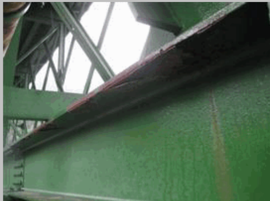
2011 105 Corrosión en cordón inferior cercha central vano 2 próxima pila 1
