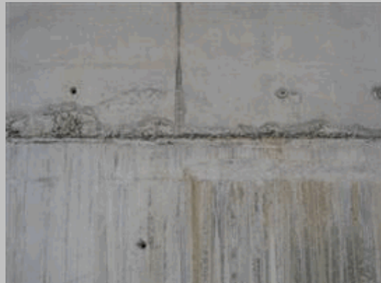
2011 39 Detalle de coqueras en pila 1 lado vano 1
