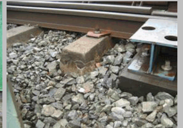
2011 154 Rotura de traviesa en transición de tablero a estribo 2
