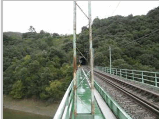
2011 165 Pátinas de óxido en poste catenaria lado izquierdo
