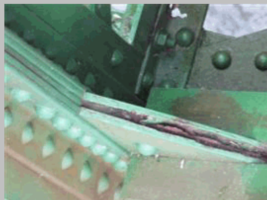
2011 126 Corrosión de cartela en cordón inferior izquierdo del vano 1
