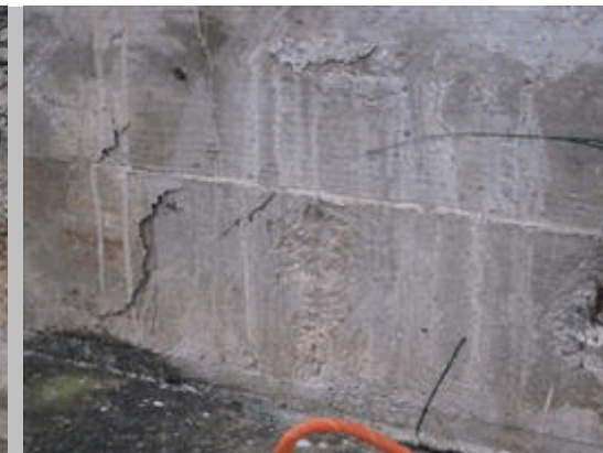
2011 13 Desconchamiento en hormigón de cargadero pila 1 lado vano 1
