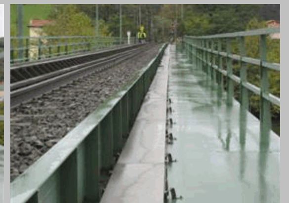
2011 159 Deformación puente vista desde estribo 2 lado izquierdo
