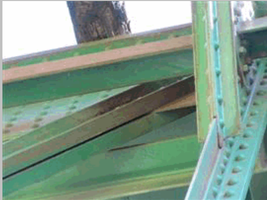
2011 33 Detalle de pátina de óxido en unión de diagonal con cordón superior en lado izquierdo del vano 1
