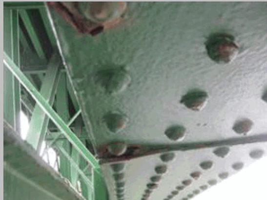
2011 52 Detalle de corrosión en cordón inferior izquierdo vano 1
