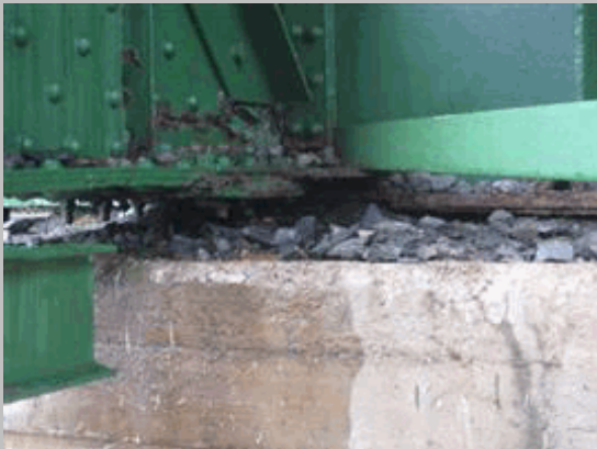
2011 126 Corrosión en nudo sobre apoyo izquierda estribo 2
