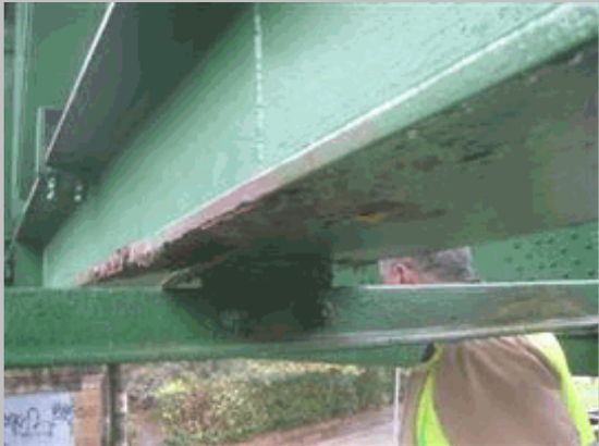
2011 76 Corrosión con pérdida de sección en cordón inferior cercha central zona máximo momento positivo vano 1
