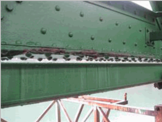
2011 51 Corrosión en cordón inferior derecho vano 1
