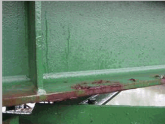
2011 48 Detalle de corrosión en cordón inferior de la cercha central vano 1
