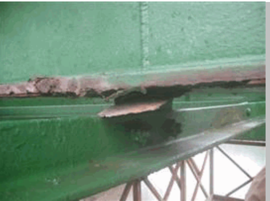
2011 74 Corrosión con pérdida de sección en cordón inferior cercha central zona máximo momento positivo vano 1
