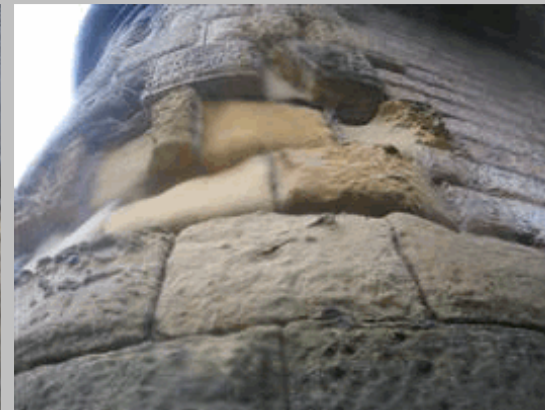
2011 197 Detalle de pérdida de sillar en pila 1 , tajamar aguas arriba
