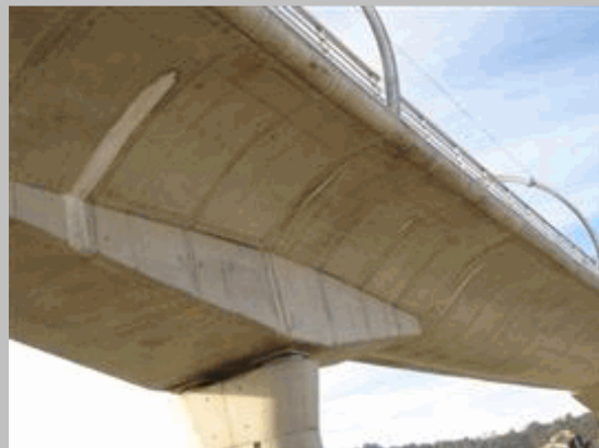
2011 24 Costra calcárea en lado izq vano 10
