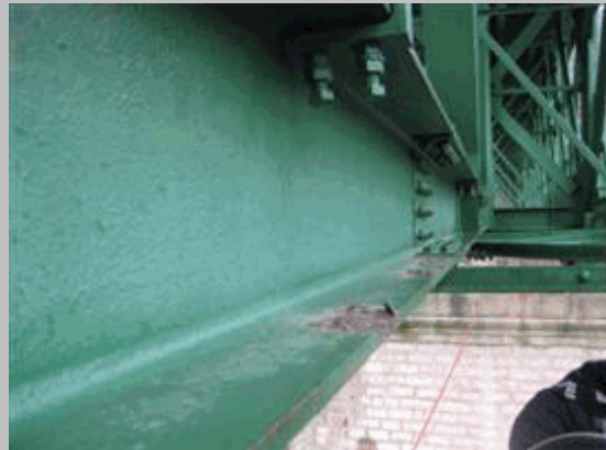
2011 54 Corrosión en cordón inferior vano central
