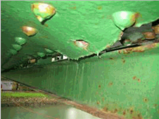
2011 05 Detalle oxidación en cordón inferior derecho próximo a pila 1 con pérdida de pernos
