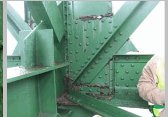
2011 94 Cartela unión cordón inferior izquierdo vano 2 con corrosión y pérdida de sección
