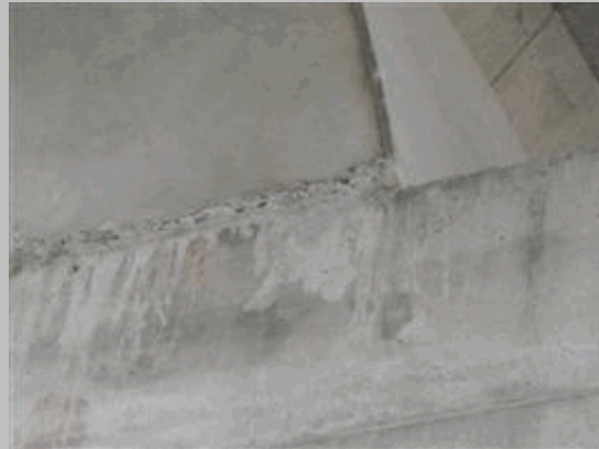
2011 48 Detalle de coqueras en pila 2 lado vano 3
