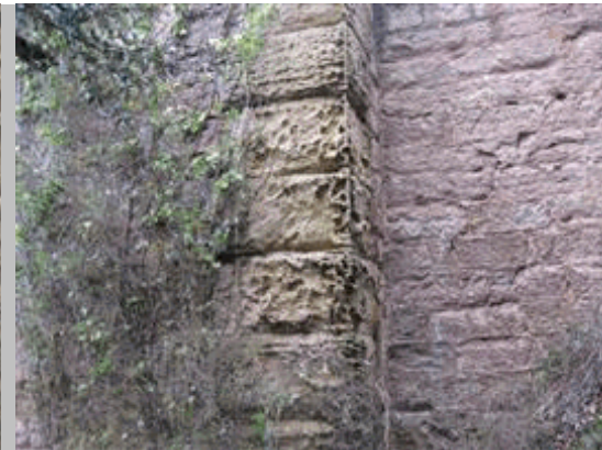
2011 147 Arenización de sillería en muro en vuelta lado derecho estribo 2
