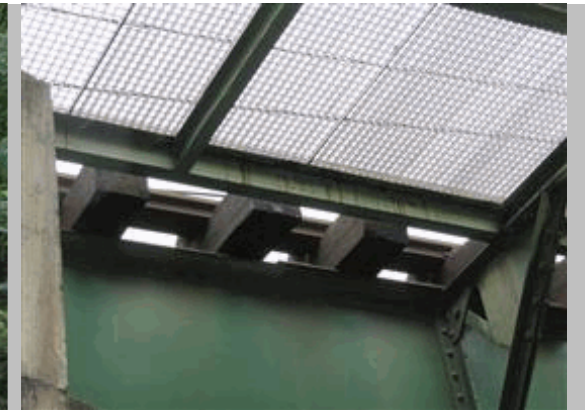
2011 74 Pátina de óxido en viga de paseo izquierdo sobre pila 2
