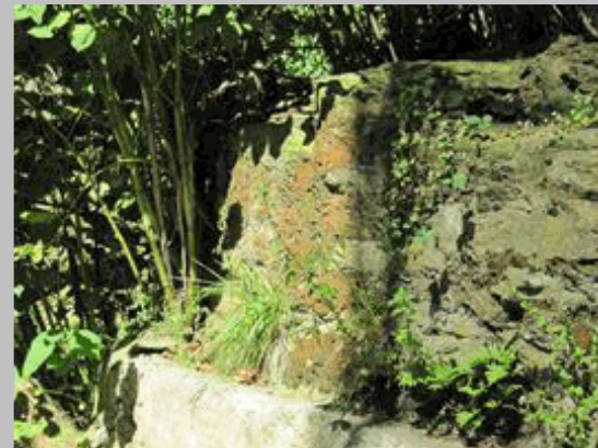
2011 46 Cimentación de conglomerado de mampuesto sobre refuerzo de hormigón en cimentación de pila 1, con abundante vegetación
