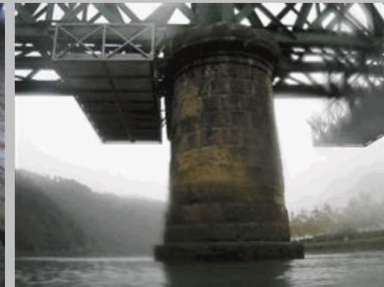
2011 198 Alzado tajamar aguas abajo con humedades y pátina biológica
