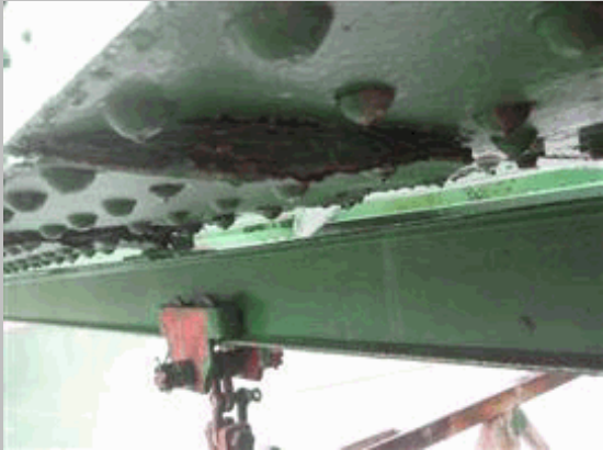
2011 81 Cordón inferior izquierdo vano 1 con corrosión en unión de pletinas
