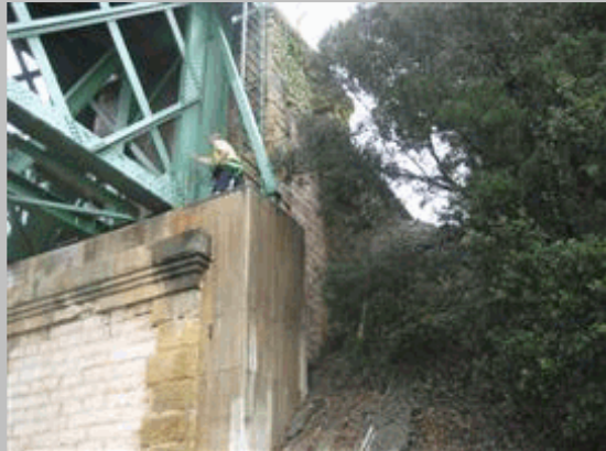
2011 135 Muro en vuelta lado derecho con vegetación enraizada
