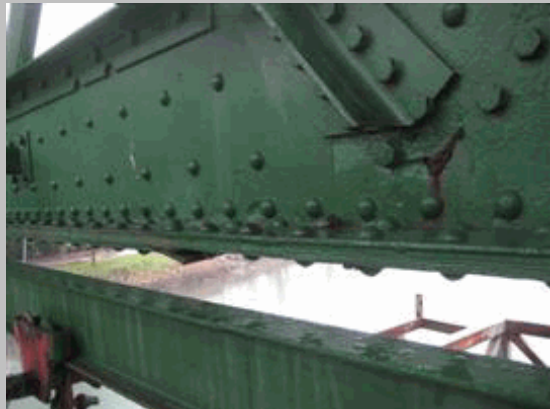
2011 50 Corrosión en unión de diagonal con cordón inferior izquierdo vano 1
