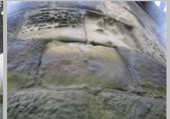
2011 199 Detalle de arenización en tajamar aguas abajo
