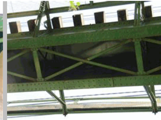
2011 58 Pátina de óxido en arriostramiento contraviento en centro de luz del vano 2
