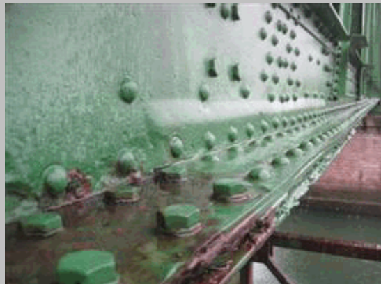
2011 112 Acumulación de agua en cordón inferior izquierdo vano 2
