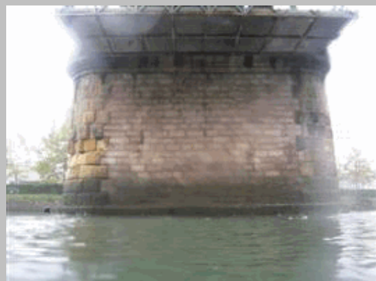
2011 201 Alzado pila lado vano 2 con humedades
