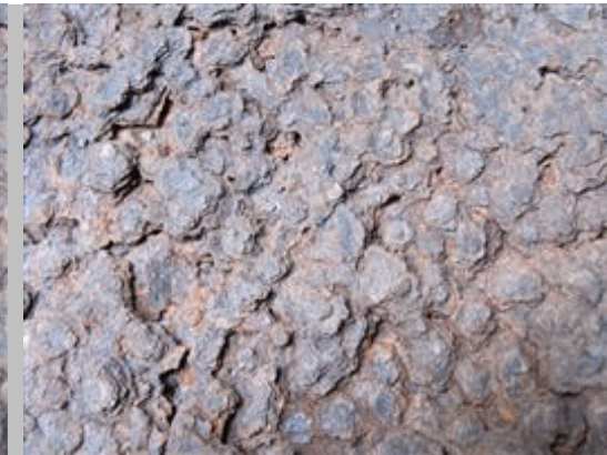
2011 193 Detalle de pletina de acero corroida
