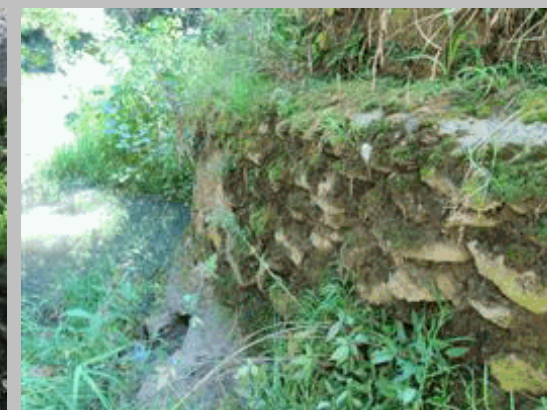
2011 53 Pátina biológica en cimentación de la pila 1 en lado del vano 2
