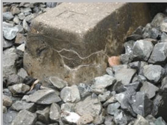
2011 155 Detalle de rotura de traviesa en transición de tablero a estribo 2
