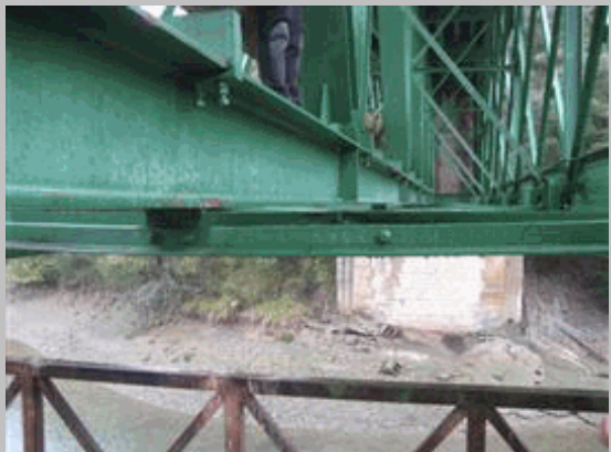
2011 114 Deformación montante contraviento en vano 2 próximo a centro luz
