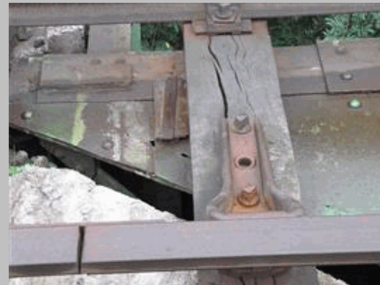
2011 106 Perforación por corrosión en chapa superior del vano 2 sobre pila 2
