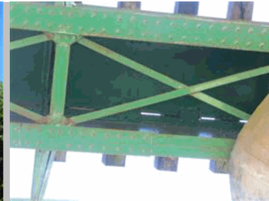
2011 57 Pátina de óxido en arriostramiento contraviento próximo a pila 1 en vano 2
