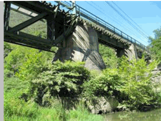
2011 41 Vista pila q desde lado derecho con vegetación enraizada
