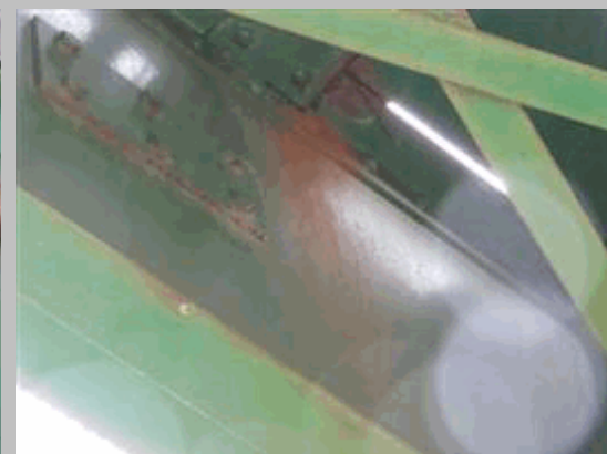
2011 82 Corrosión en ala superior y pátina de óxido en alma de viga izquierda del vano3
