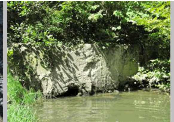
2011 44 Pequeña socavación en refuerzo de hormigón de la cimentación de la pila 1 en la parte derecha, con abundante vegetación enraizada
