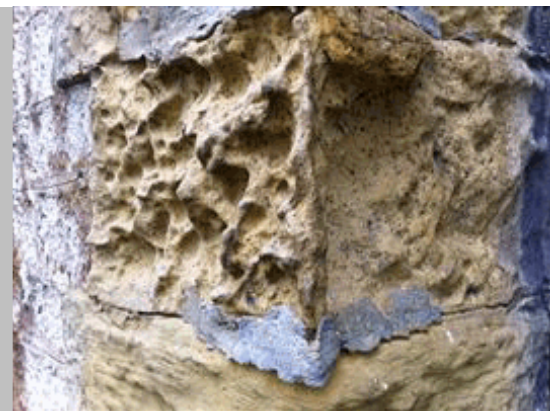
2011 206 Alveolización de sillar en E-1
