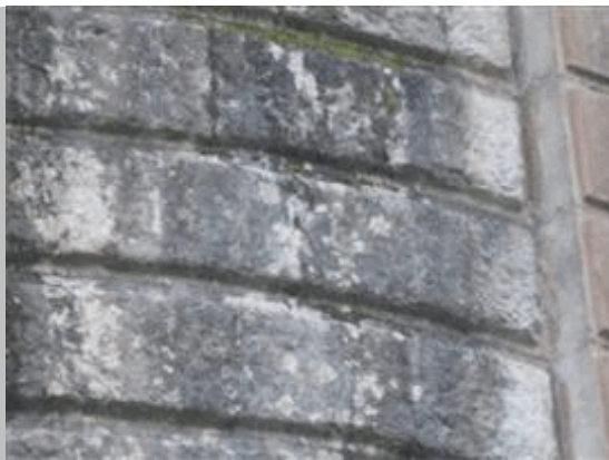
2011 13 Humedades y pátina biológica en estribo 1
