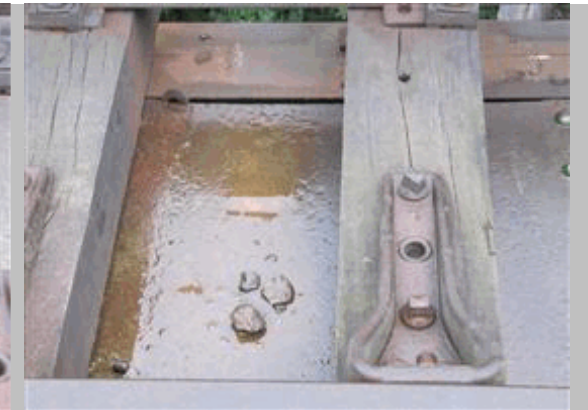
2011 104 Acumulación de agua en chapa superior del vano 3
