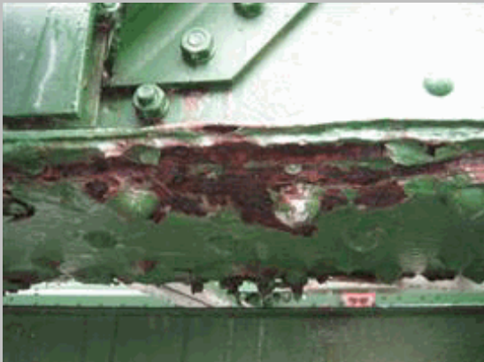
2011 36 Detalle corrosión con pérdida de sección cordón inferior lado derecho vano 1
