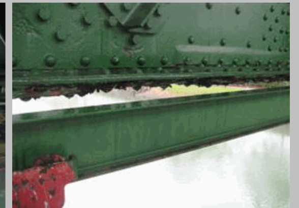
2011 19 Detalle de oxidación de cordón inferior lado derecho próximo a pila 1 vano 1 con pérdida de sección
