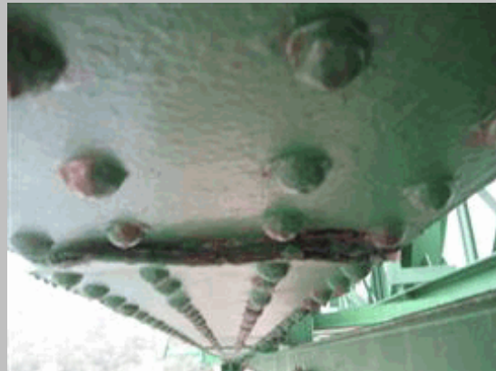
2011 53 Detalle de corrosión en cordón inferior izquierdo vano 1 en unión de pletinas
