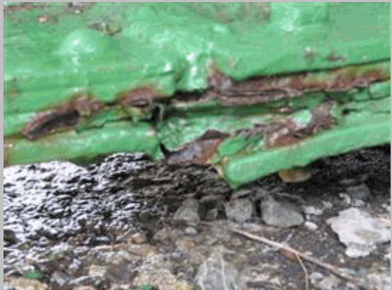
2011 189 Detalle de corrosión ala inferior derecha sobre apoyo en estribo 1
