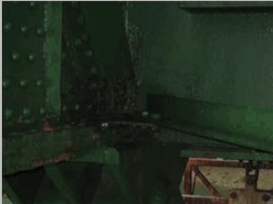
2011 09 Detalle de oxidación en nudo sobre apoyo izquierdo en pila 1 vano 1
