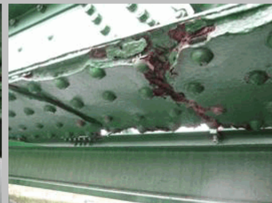
2011 22 Detalle de oxidación en cordón inferior lado derecho próximo a pila 1 vano 1 con pérdida de sección
