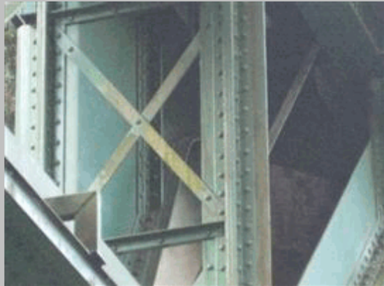
2011 30 Detalle de pátina de óxido marco de arriostramiento vertical próximo a estribo 1
