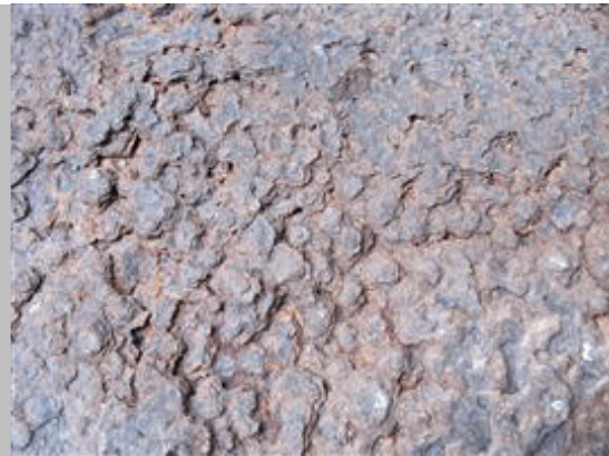
2011 191 Detalle de pletina de acero corroida
