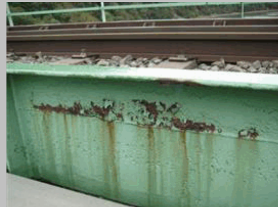
2011 166 Corrosión en murete guardabalasto en paseo izquierdo
