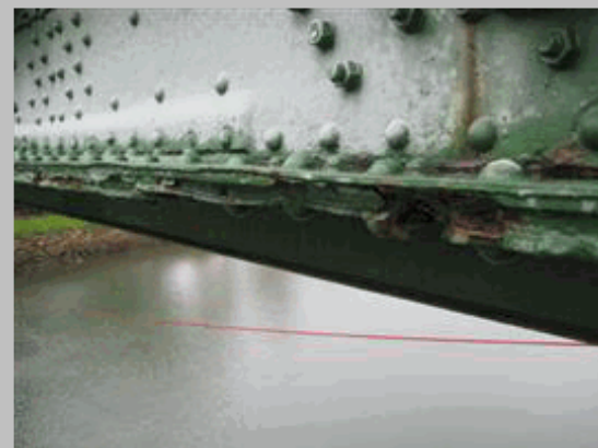
2011 21 Detalle de oxidación en cordón inferior lado derecho próximo a pila 1 vano 1 con pérdida de sección
