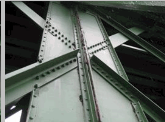
2011 92 Corrosión con pérdida de sección en lado derecho pila 1
