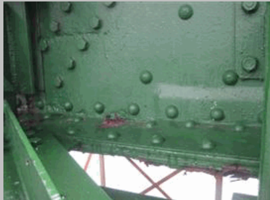
2011 37 Pérdida de bulón por corrosión en cordón inferior derecho vano1
