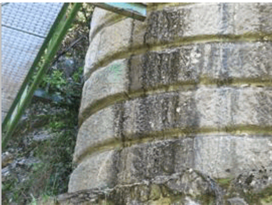
2011 11 Humedades en estribo 1
