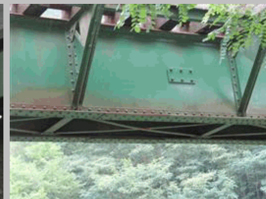
2011 67 Pátina de óxido en viga izquierda del vano 2, entre pila 2 y centro de luz
