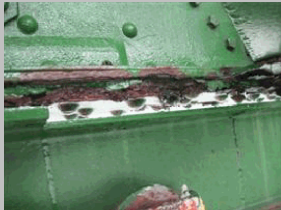
2011 107 Detalle de corrosión en cordón inferior lado izquierdo en vano 2 próximo a pila 1
