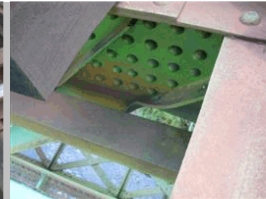
2011 118 Deformación de ala inferior de diagonal de celosía del vano 1 en estribo 1
