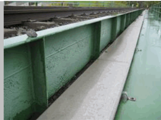
2011 161 Corrosión en murete guardabalasto en paseo izquierdo
