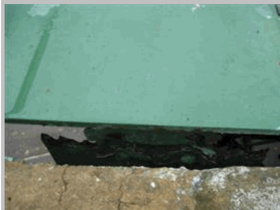
2011 170 Corrosión montante vertical con unión de chapa ortótropa
