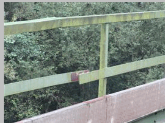
2011 111 Rotura de unión de barandilla derecha por corrosión sobre pila 1
