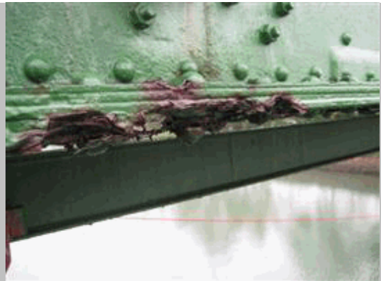
2011 29 Detalle de oxidación en cordón inferior izquierdo con pérdida de sección en vano 1
