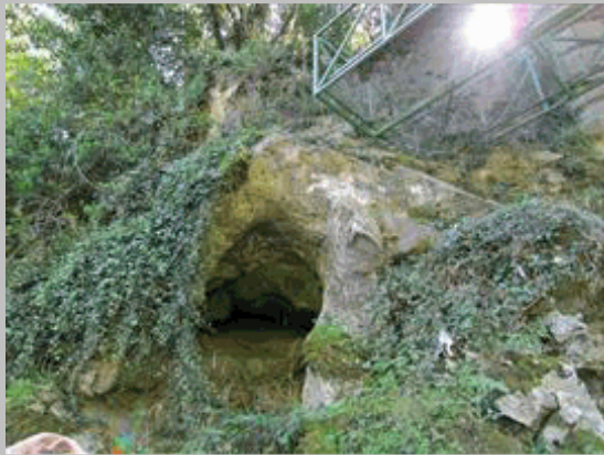
2011 18 Socavón próximo a estribo 1
