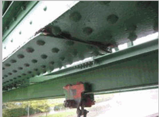
2011 39 Corrosión en unión de pletinas en cordón inferior derecho vano 1
