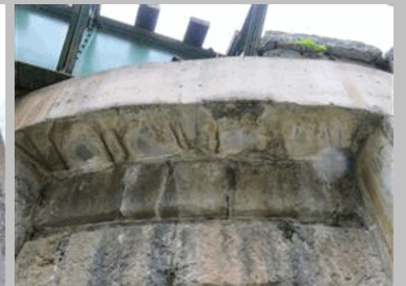
2011 94 Humedades en sillería y contrafuerte de hormigón en estribo 2 en lado derecho
