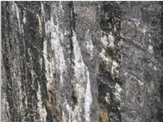
2011 177 Humedades, pátina biológica y costra calcárea en muro en vuelta lado izquierdo estribo 1
