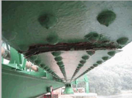
2011 45 Corrosión de unión de pletinas de cordón inferior derecho visto desde abajo vano 1
