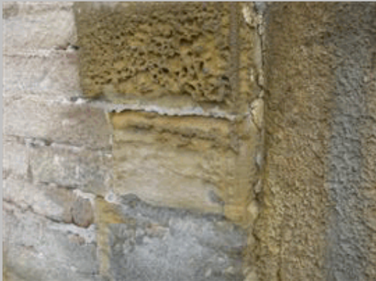
2011 136 Arenización de sillería en estribo 2 lado derecho
