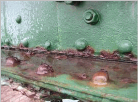
2011 109 Detalle de acumulación de agua en cordón inferior derecho vano 2 próximo a pila 1
