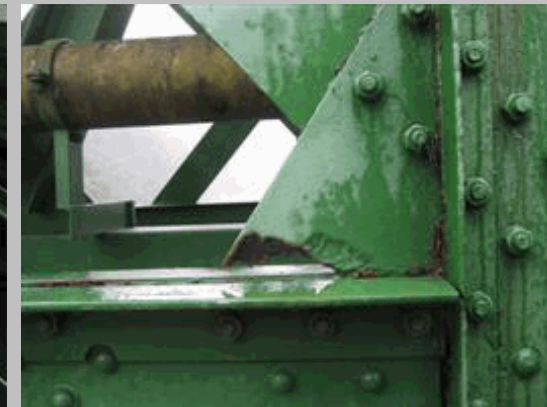
2011 93 Cartela unión cordón inferior izquierdo vano 2 con corrosión y pérdida de sección
