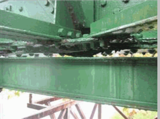
2011 84 Detalle unión en cordón inferior derecho con corrosión vano 1
