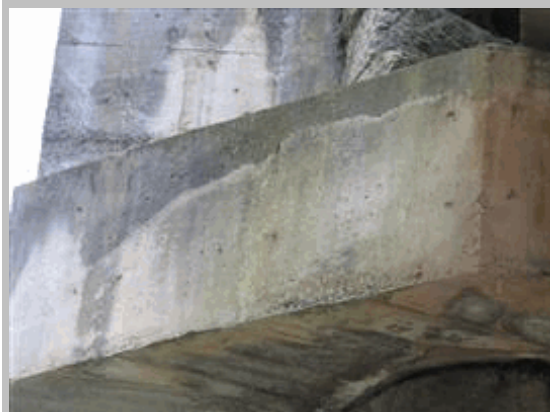
2011 95 Pátina biológica y humedades en contrafuerte de hormigón en lado izquierdo del estribo 2
