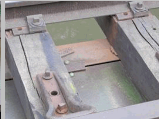
2011 107 Pátina de óxido en ala superior de viga derecha del vano 2
