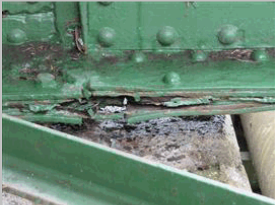
2011 187 Detalle de corrosión en cordón inferior izquierdo en apoyo sobre estribo 1 con pérdida de sección
