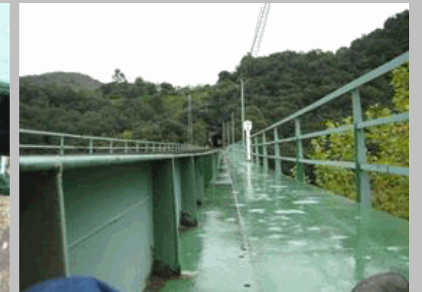
2011 169 Deformación puente vista desde estribo 1 lado derecho
