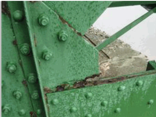
2011 133 Detalle de corrosión en cartela de nudo sobre apoyo izquierda estribo 2
