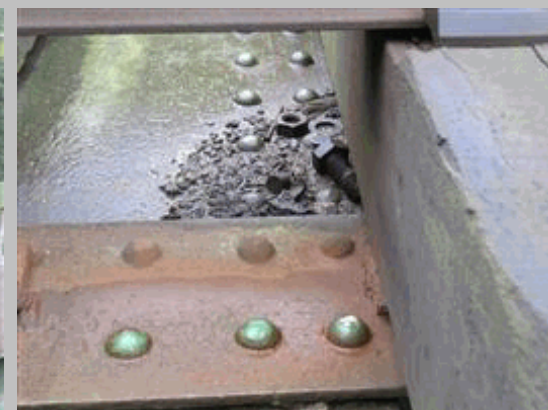
2011 112 Acumulación de escombros sobre chapa superior en vano 1 próximo a pila 1
