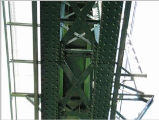
2011 23 Detalle de pátina de óxido en arriostramiento vertical en centro de luz, en vano 1
