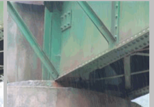
2011 64 Pátina de óxido en el alma de la viga derecha del vano 2 sobre pila 1
