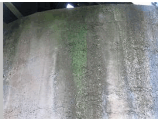
2011 86 Pátina biológica en el cargadero de la pila 2, en el lado del vano 3
