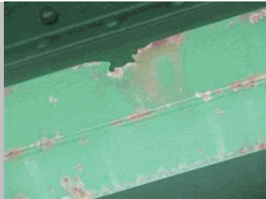
2011 118 Detalle de corrosión en rigidizador de chapa ortótropa superior en vano 2
