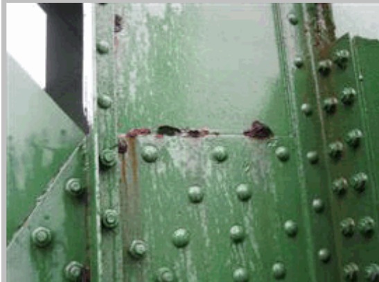
2011 90 Montante apoyo derecho pila 1 vano 1 con corrosión
