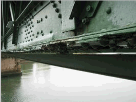
2011 121 Corrosión de cordón inferior derecho en vano 2 con pérdida de sección
