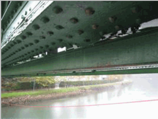
2011 03 Pérdida de pernos en cordón inferior derecho debido a oxidación próxima a pila 1 vano 1
