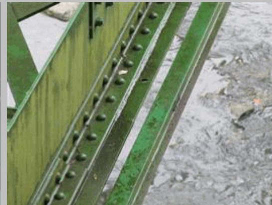
2011 122 Acumulación de agua en cordón inferior derecho del vano 1, próximo al estribo 1
