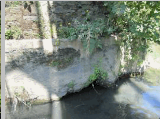
2011 47 Socavación en cimentación de pila 1 en el lado izquierdo
