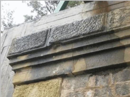
2011 142 Humedades y pequeña rotura en sillería
