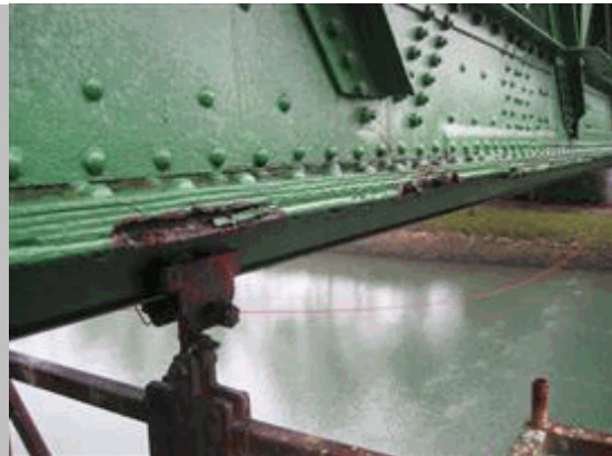
2011 28 Oxidación del cordón inferior izquierdo con pérdida de sección en vano 1
