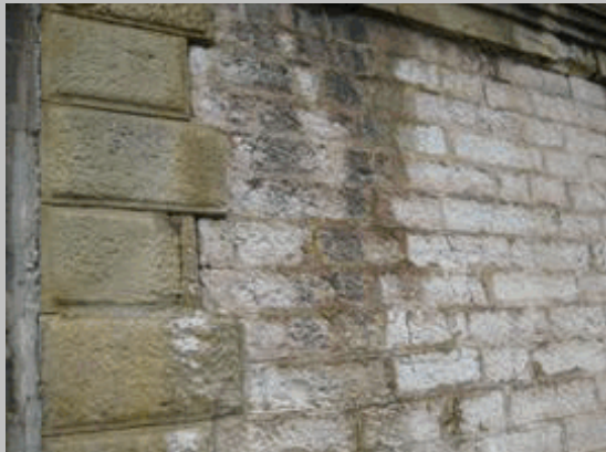
2011 144 Humedades en fábrica de estribo 2 lado izquierdo
