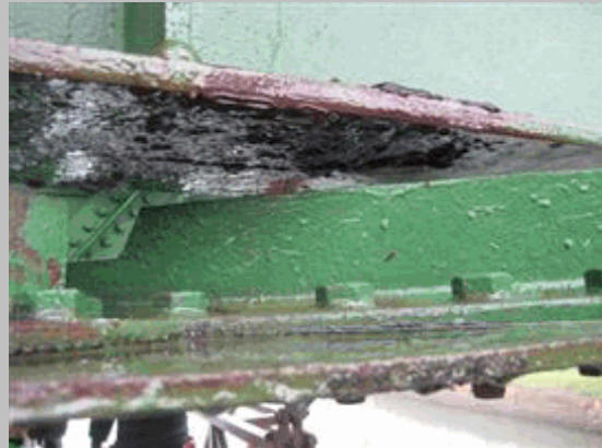
2011 49 Corrosión en cordón inferior de la cercha central vano 1
