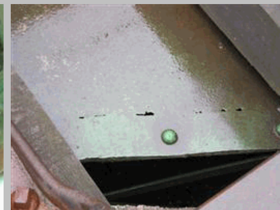
2011 128 Perforación por corrosión en chapa superior del vano 1, sobre pila 1
