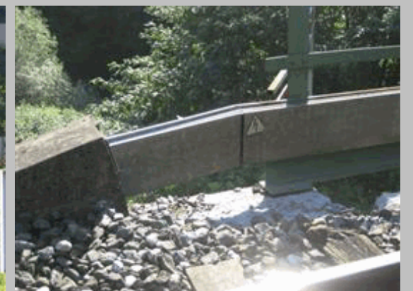
2011 99 Detalle servicio existente en lado derecho de la plataforma
