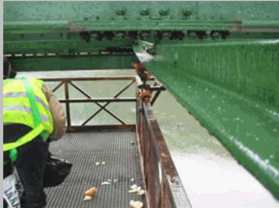
2011 120 Deformación montante contraviento en vano 2 próximo a centro luz
