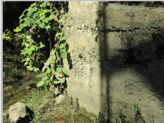
2011 45 Coqueras en refuerzo de hormigón de la cimentación de la pila 1
