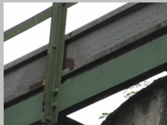
2011 66 Pátina de óxido en barandilla derecha sobre pila 1
