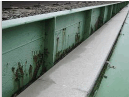
2011 160 Corrosión en murete guardabalasto en paseo izquierdo
