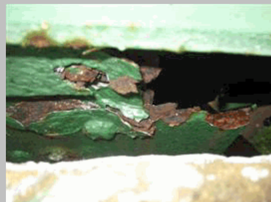
2011 171 Detalle de corrosión montante vertical con unión de chapa ortótropa
