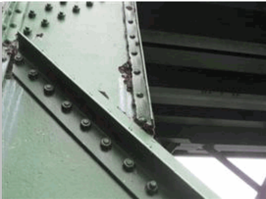
2011 132 Corrosión en montante vertical de cercha izquierda sobre apoyo en estribo 2
