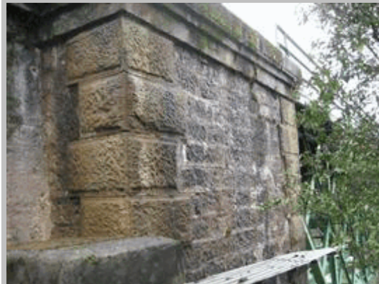
2011 150 Muro en vuelta lado izquierdo con humedades y pátinas biológicas
