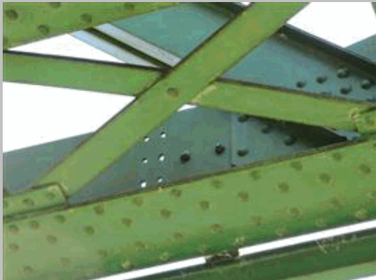
2011 37 Alma del cordón inferior derecho agujereada próximo a pila 1
