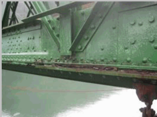
2011 66 Vista de cordón inferior izquierdo con corrosión y pérdida de sección en zona de máximo momento positivo vano 1
