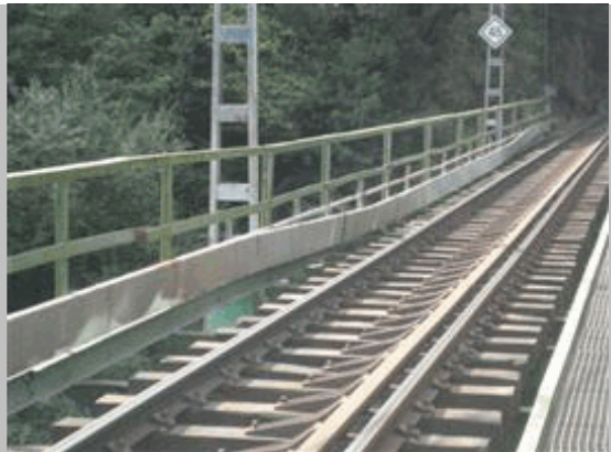
2011 130 Servicio existente mal anclado en vano 1
