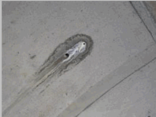
2011 51 Detalle de costra calcárea en vano 4 lado izq
