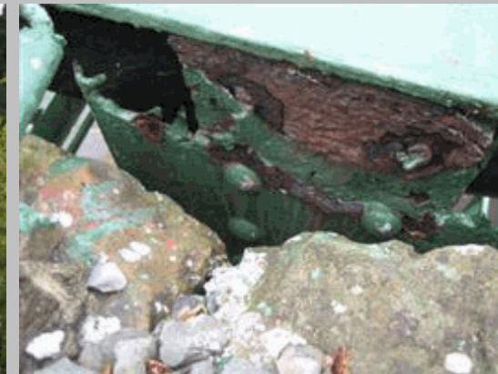
2011 168 Detalle de corrosión de montante vertical lado derecho en unión con chapa ortótropa superior
