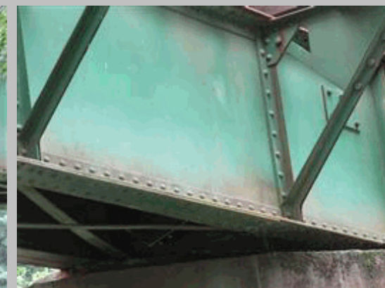
2011 68 Pátina de óxido en el alma de viga izquierda del vano 2 sobre pila 1
