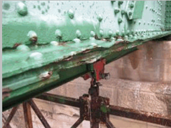
2011 122 Corrosión de cordón inferior izquierdo con aumento de violumen
