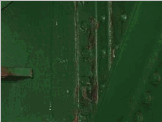
2011 08 Detalle de oxidación con pérdida de sección en cartela de nudo sobre apoyo derecho en pila 1 vano 1
