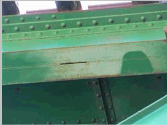
2011 20 Descascarillamiento en cordón superior izquierdo del vano 1
