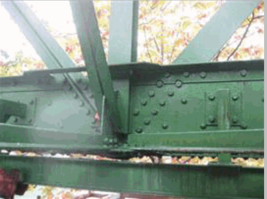
2011 83 Unión en cordón inferior derecho con corrosión vano 1
