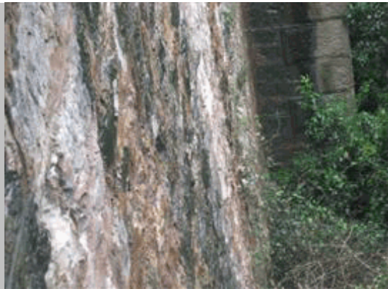
2011 175 Detalle de humedades en muro en vuelta derecho estribo 1 con humedades
