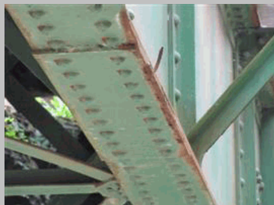
2011 81 Detalle de corrosión del ala inferior de viga izquierda del vano 3
