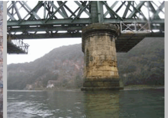
2011 194 Tajamar aguas arriba pila q con arenización y pérdidas de sillar
