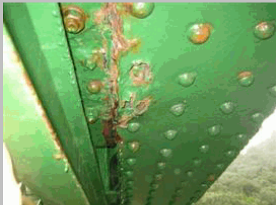
2011 110 Detalle de corrosión y pérdida de roblones en cordón inferior derecho vano 2
