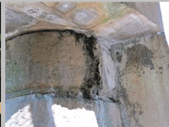
2011 93 Pátina biológica en sillería del estribo 2
