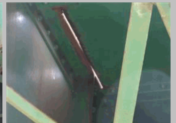
2011 84 Corrosión del ala superior de viga izquierda del vano 3, próximo a estribo 2
