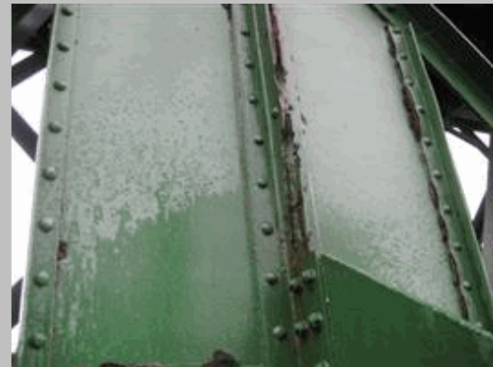
2011 91 Corrosión con pérdida de sección en lado derecho pila 1
