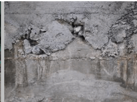
2011 12 Detalle de coqueras en hormigón de cargadero pila 1 lado vano 1
