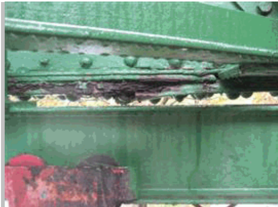
2011 85 Detalle de corrosión cordón inferior izquierdo con corrosión y pérdida de sección
