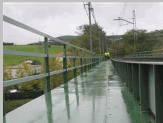
2011 156 Deformación puente vista desde estribo 2 lado izquierdo
