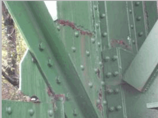
2011 125 Detalle de cartela corroida en cercha izquierda sobre apoyo en estribo 2
