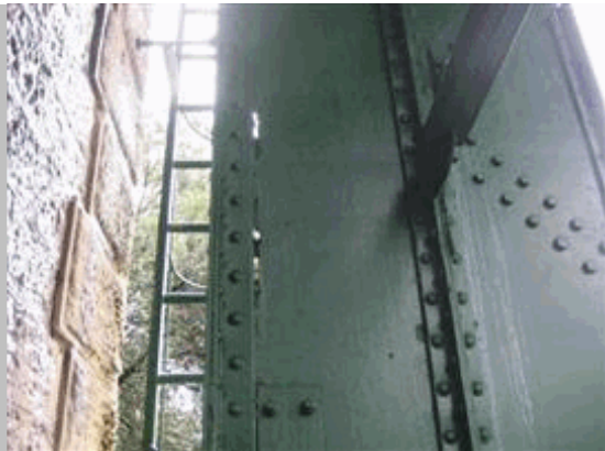
2011 130 Corrosión en montante vertical de cercha derecha sobre apoyo en estribo 2
