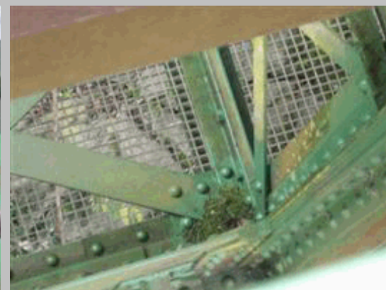
2011 127 Pátina biológica en cordón inferior izquierdo, próximo a estribo 1
