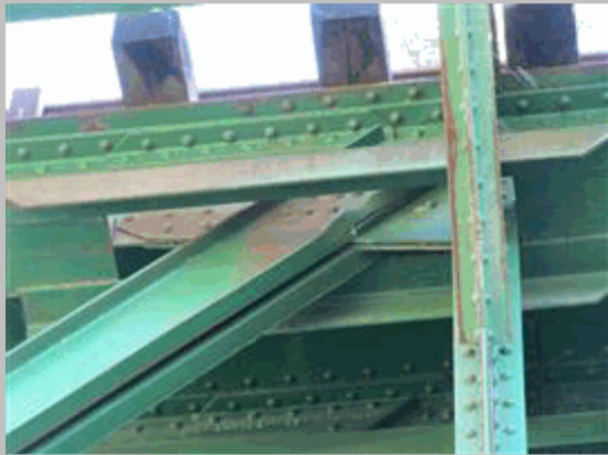
2011 19 Pátina de óxido en lado izquierdo del vano 1, en unión entre diagonal y cordón superior
