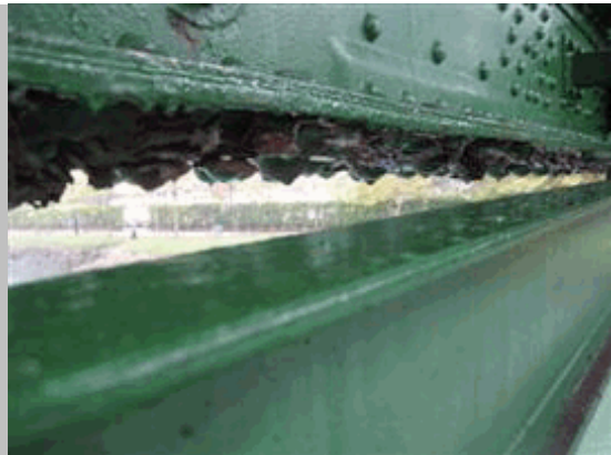
2011 27 Detalle de oxidación cordón inferior derecho con pérdida de sección en vano 1
