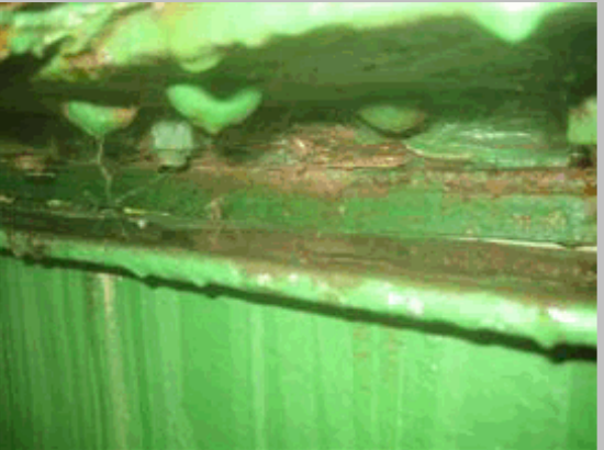
2011 78 Detalle de corrosión en cordón inferior izquierdo en nudo vano 1
