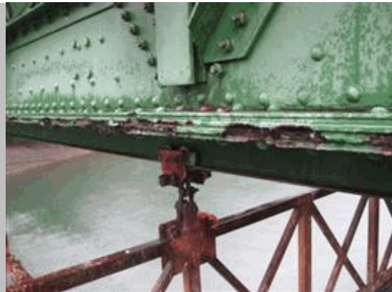
2011 103 Corrosión con pérdida de sección de cordón inferior izquierdo vano 2 próximo pila 1
