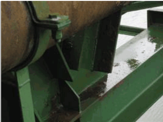
2011 131 Detalle de corrosión en diagonal cercha central
