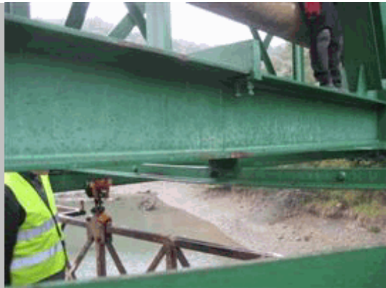
2011 115 Deformación montante contraviento en vano 2 próximo a centro luz
