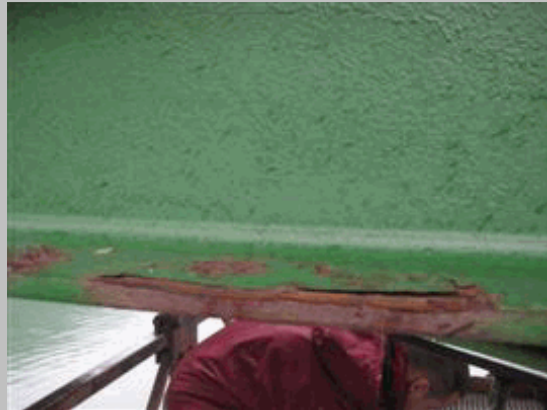
2011 47 Detalle de corrosión en cordón inferior de la cercha central vano 1
