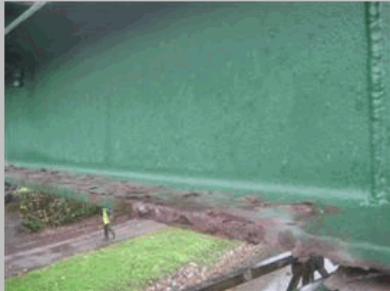
2011 75 Corrosión con pérdida de sección en cordón inferior cercha central zona máximo momento positivo vano 1
