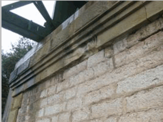
2011 139 Arenización en sillería en estribo 2
