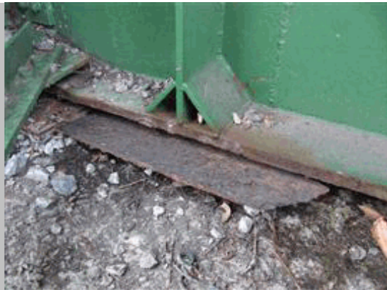
2011 190 Pletina de acero corroida desprendida bajo cercha central en estribo 1
