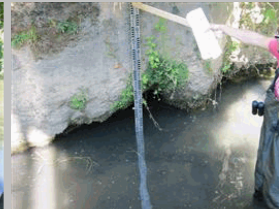
2011 48 Altura de socavación en cimentación de pila 1
