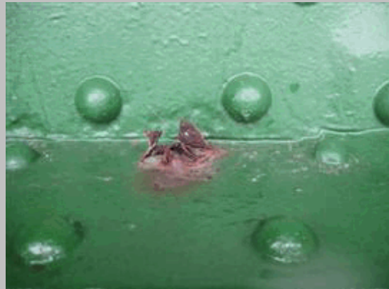
2011 38 Detalle de pérdida de bulón por corrosión en cordón inferior derecho vano1
