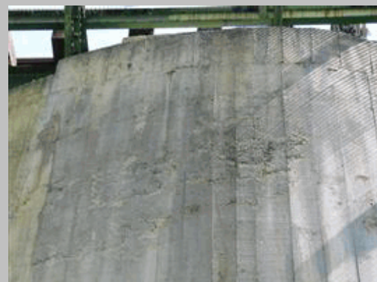
2011 51 Coqueras en el cargadero de la pila 1 en el lado izquierdo
