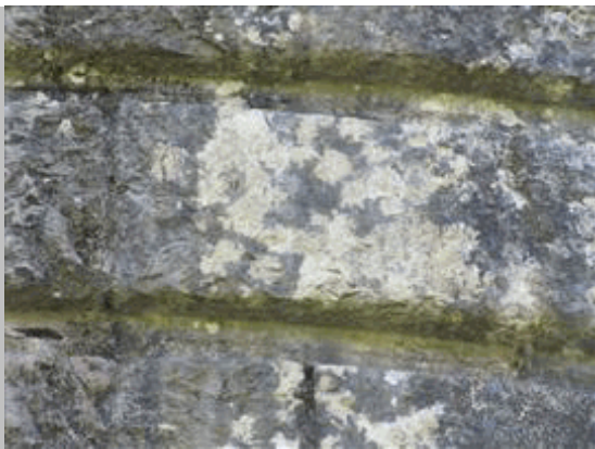
2011 12 Depositos de cal en estribo 1
