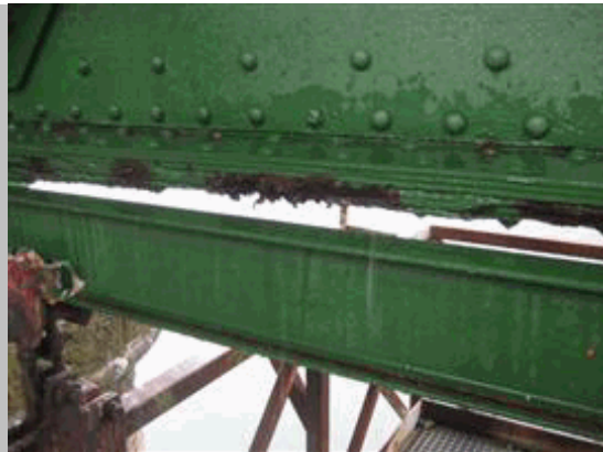
2011 102 Corrosión con pérdida de sección de cordón inferior izquierdo vano 2 próximo pila 1
