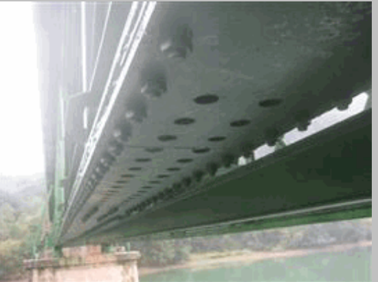
2011 79 Corrosión con pérdida de sección en cordón inferior cercha central zona máximo momento positivo vano 1
