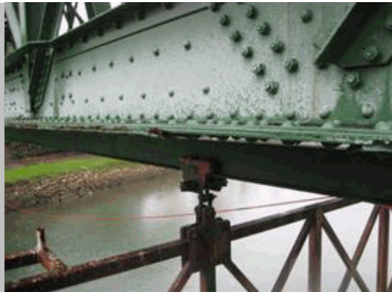
2011 40 Cordón inferior derecho con corrosión
