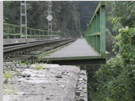
2011 101 Viga izquierda con deformación desde estribo 2
