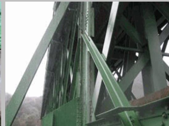
2011 17 Oxidación en montante vertical sobre apoyo izquierdo pila 1 vano1
