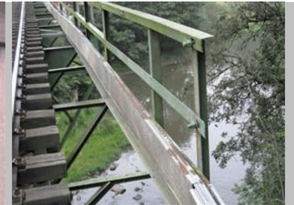
2011 119 Pátinas de óxido en barandilla derecha y servicio existente, sobre estribo q
