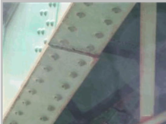
2011 65 Pátina de óxido en ala inferior de viga derecha del vano 2, en centro de luz
