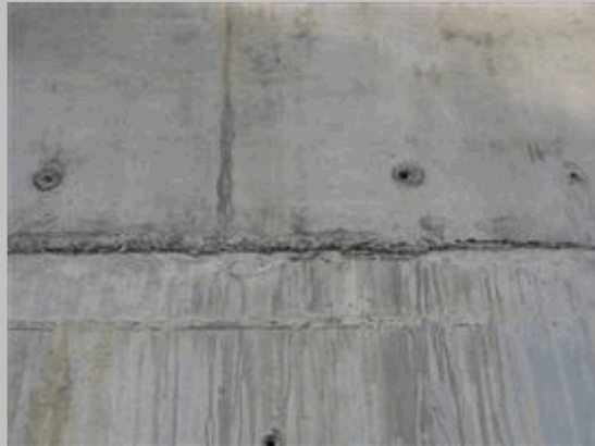
2011 46 Detalle de coqueras pila 1 lado vano 2
