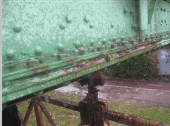
2011 80 Cordón inferior izquierdo vano 1 con corrosión, pátina biológica y acumulación de agua
