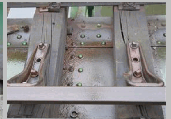
2011 114 Corrosión de cordón superior derecho y chapa superior del vano 1, próximo a pila 1
