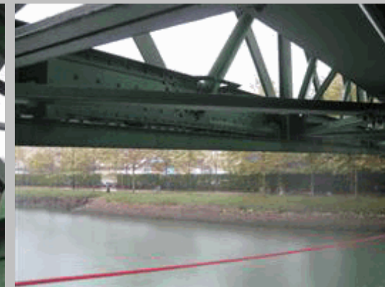
2011 18 Oxidación cordón onferior derecho vano 1 próximo a pila1
