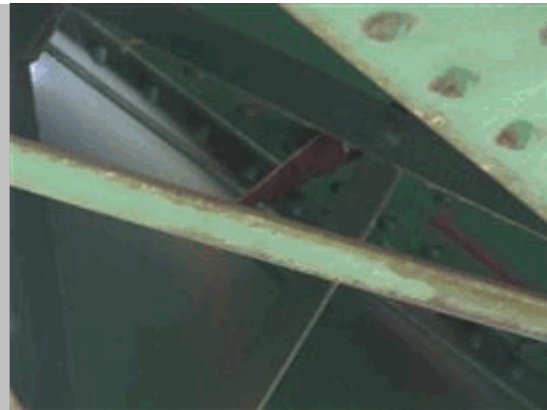
2011 71 Corrosión en chapa superior junto a ala superior de viga derecha del vano 2 en centro de luz
