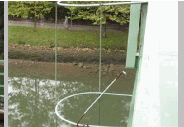
2011 164 Rotura de protección de escalera de descenso pila 1
