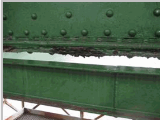
2011 20 Detalle de oxidación en cordón inferior lado izquierdo próximo a pila 1 vano 1
