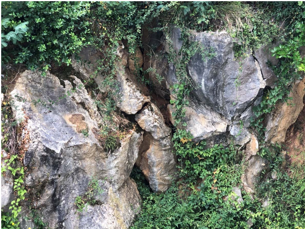
Detalle de cuña inestable
