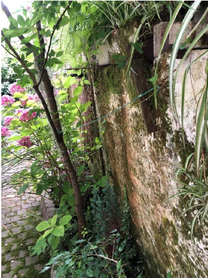
Muro de bloques con vuelco
