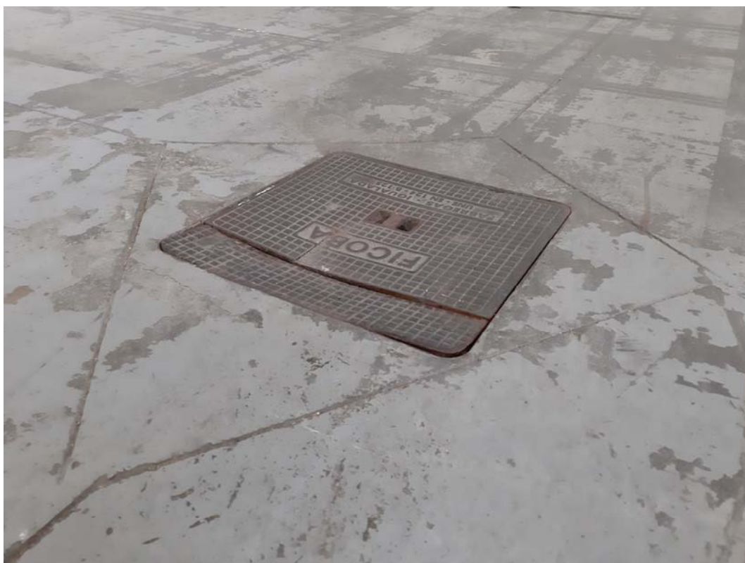
Foto.05 Vista de las Tapas de las Arquetas.
