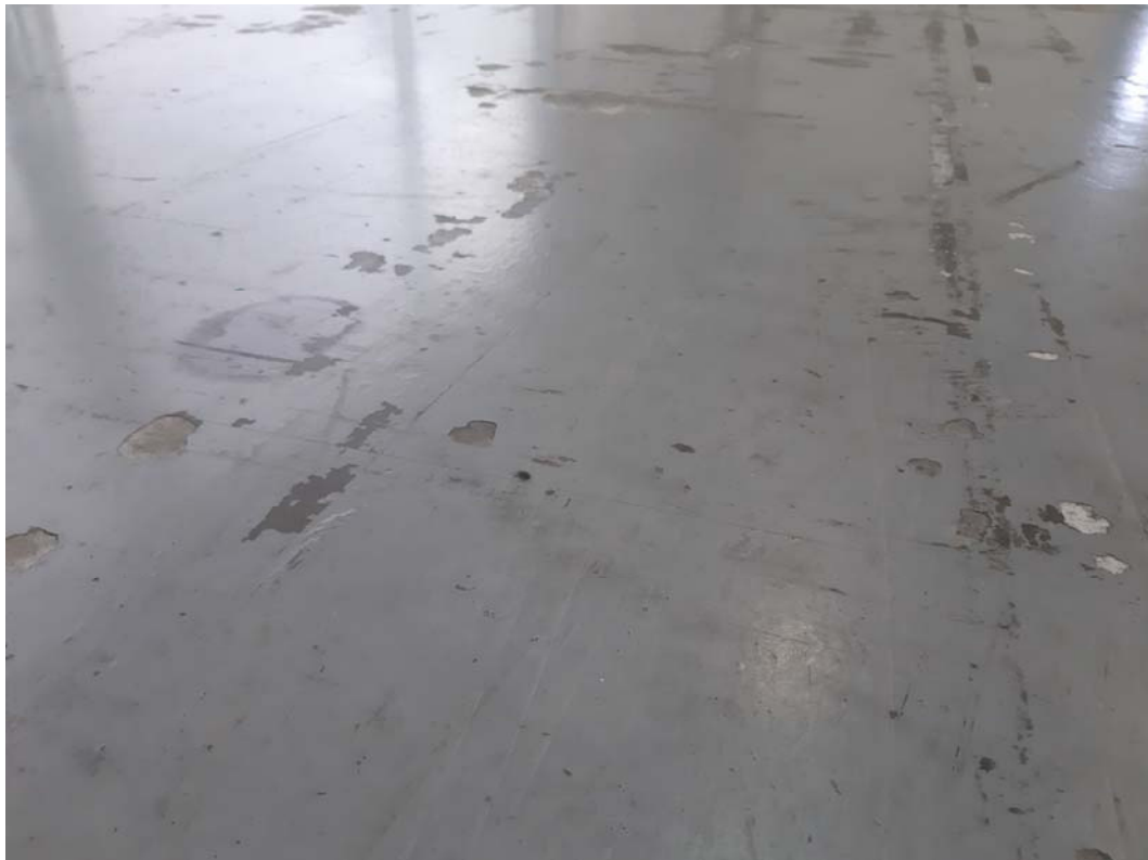
Foto.06 Vista del Estado Actual del Pavimento y sus Patologías.
