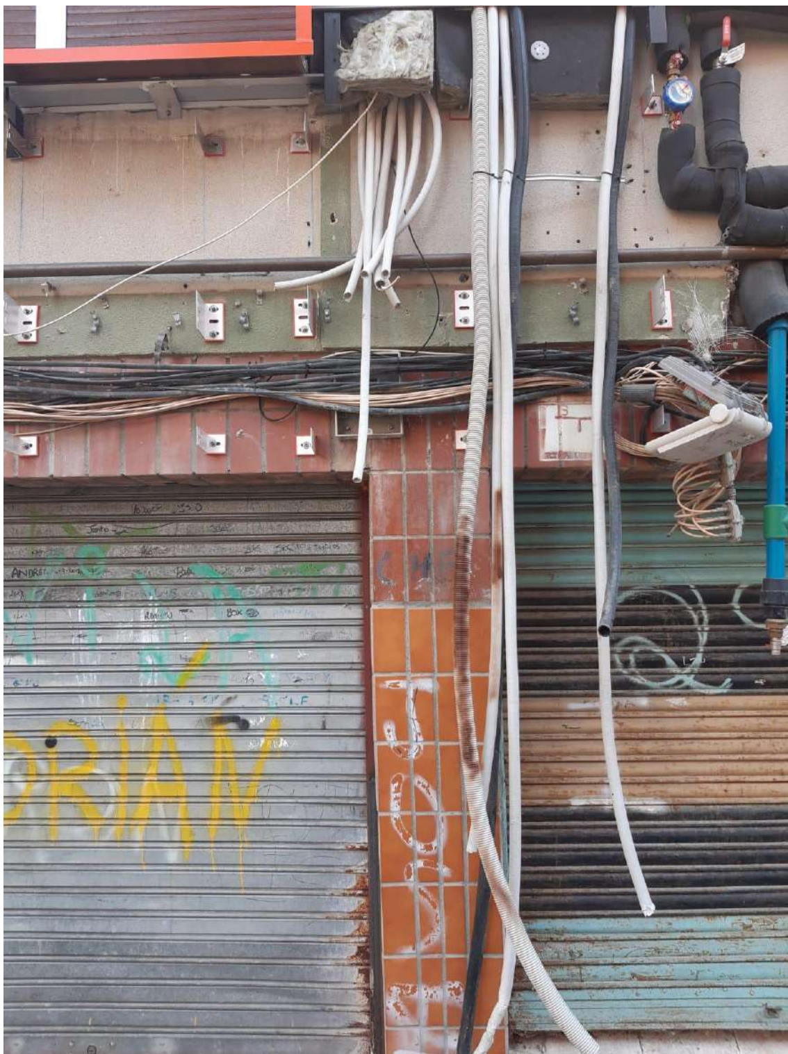
Figura 4: tubos corrugados que conectan el tejado del edificio con el local eléctrico donde se instalará el inversor SUN2000-20KTL-M2.
