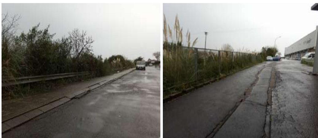
Evolución de las patologías del vial en coronación en noviembre del 2025
