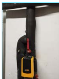
Conexinados con llaves de agua fría en sala de calderas
