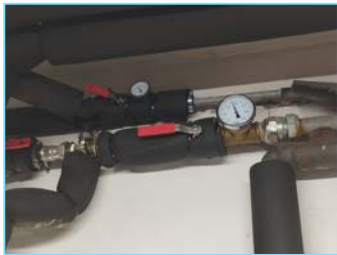
Conexinados con llaves de agua caliente en sala de calderas
