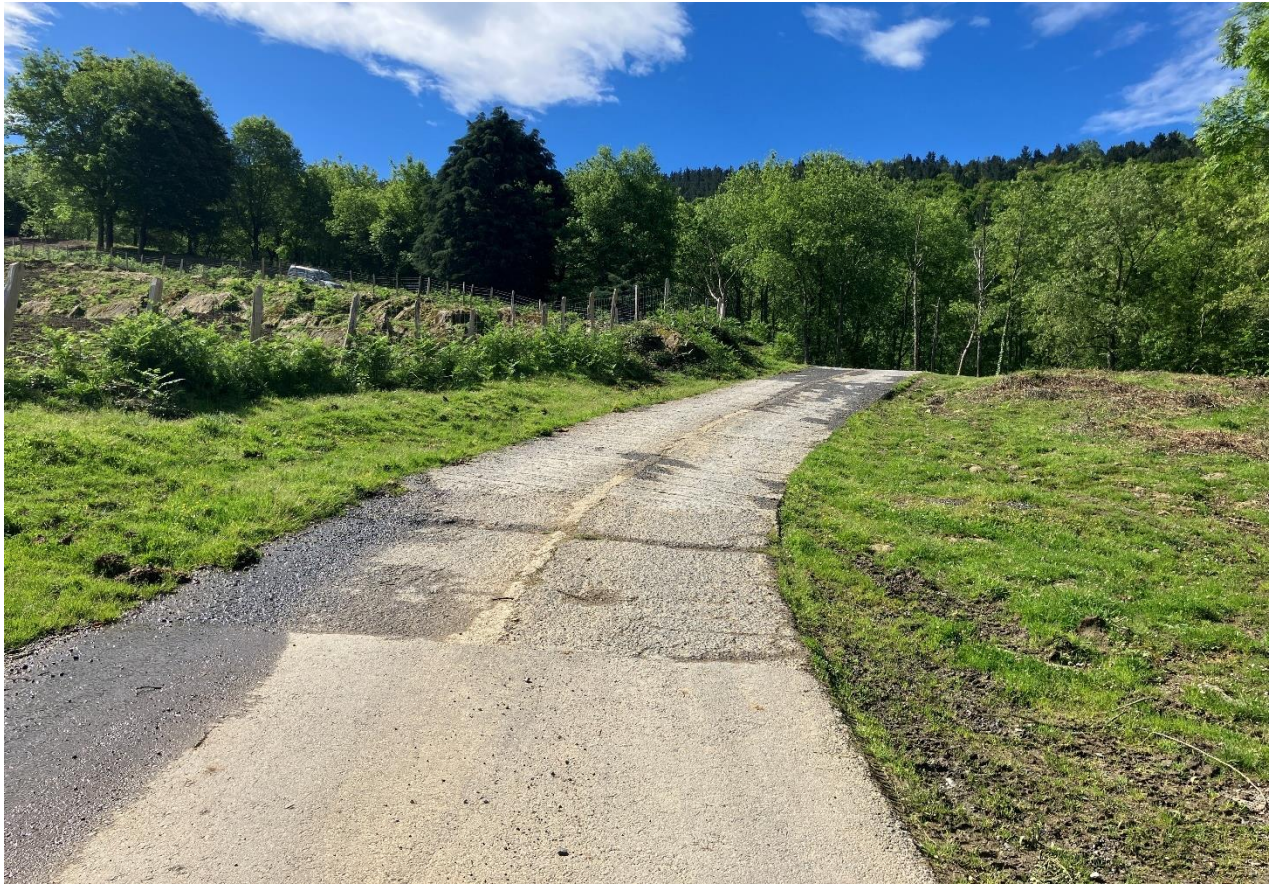
Encuentro entre parte asfaltada y hormigonada (P.K. +1,330)
