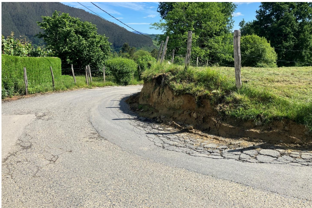
3º curva dañada por el paso de los camiones (P.K. +0,900)
