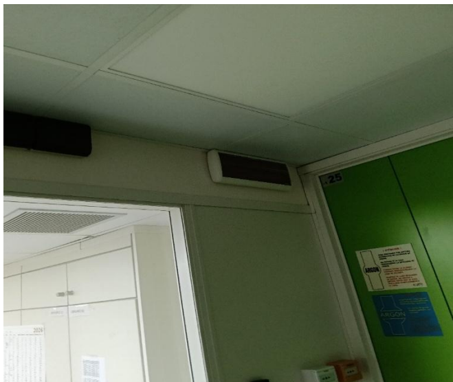
Pulsador Manual Paro Extinción PASS Letrero indicador Extinción disparada
