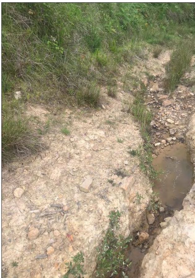
Imagen 6:y 7 Rodal 1. La falta de cortes de agua y cunetas ha provocado la erosión de la caja de la pista principal y en general de la red interior de pistas.
