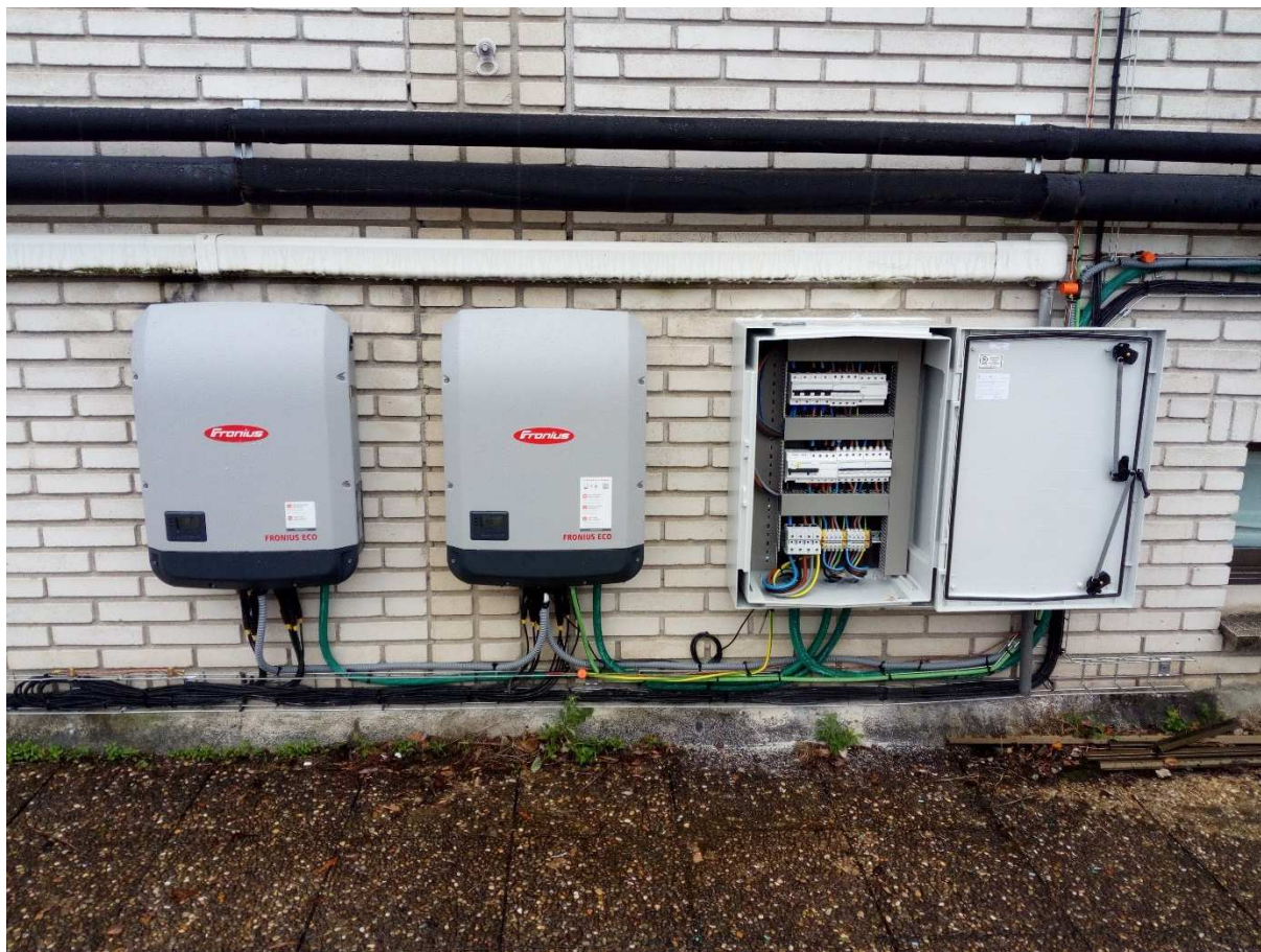
Ubicación del inversor y su cuadro AC de la instalación antigua.
