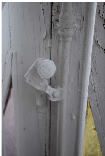
Acumulaciones de pintura
