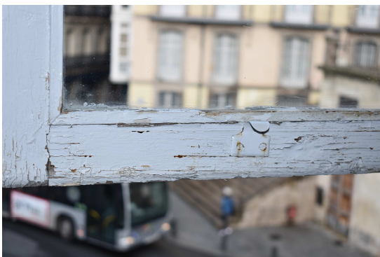
Estado de la pintura
