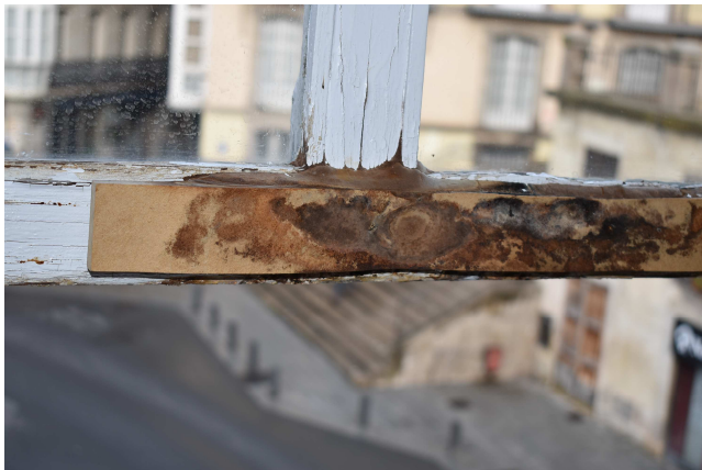
Refuerzo de madera DM afectada por hongos
