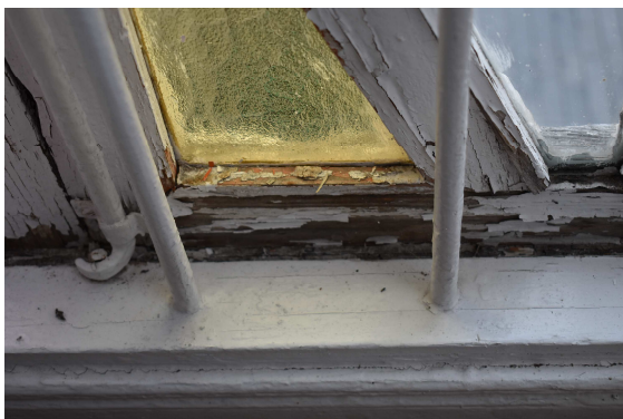
Estado de la pintura
