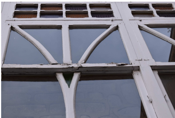
Deformaciones y pérdidas en el soporte
