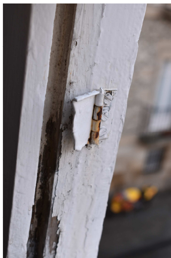
Oxidación de elementos metálicos
