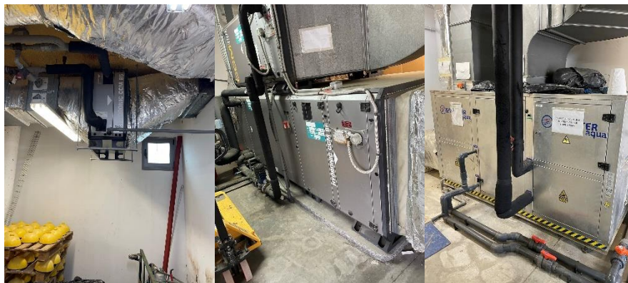
Ilustración 4. Batería post-calentamiento (izquierda), UTA aire primario (centro) y deshumectadora (derecha).
