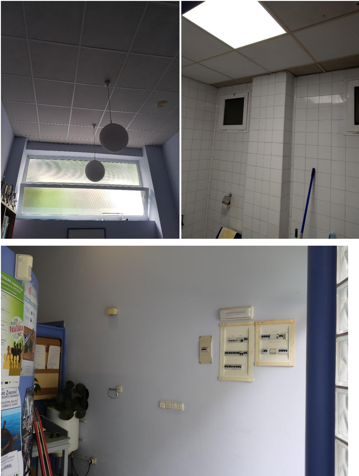
VISTAS SISTEMAS DE ILUMINACIÓN (PB Y ENTREPLANTA) Y CUADRO GENERAL.
