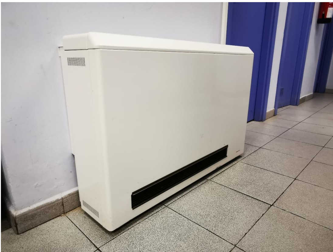
VISTAS ACUMULADORES DE CALOR.
