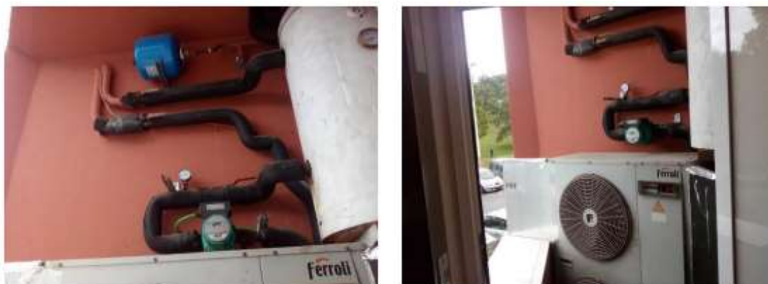
Figura 3.- Sistemas de Bombeo
