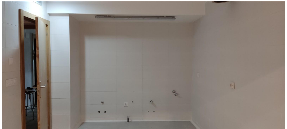
Zona de lavado
