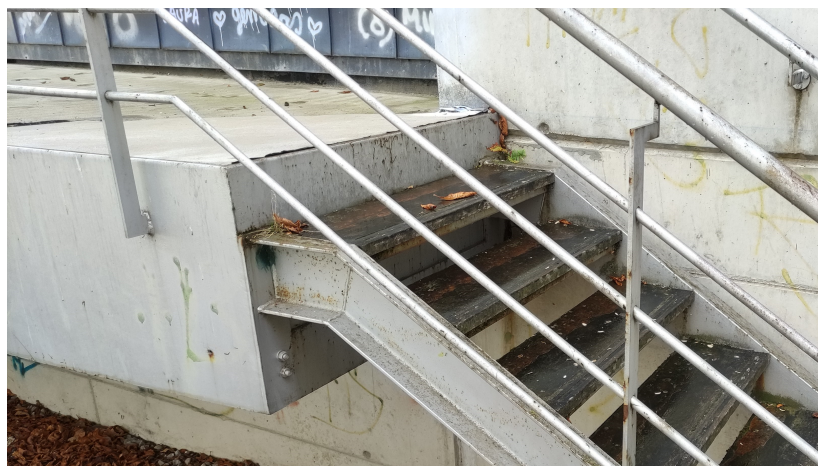
Peldaños de madera a sustituir
