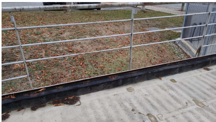
Barandilla existente y deficiencias aparentes
