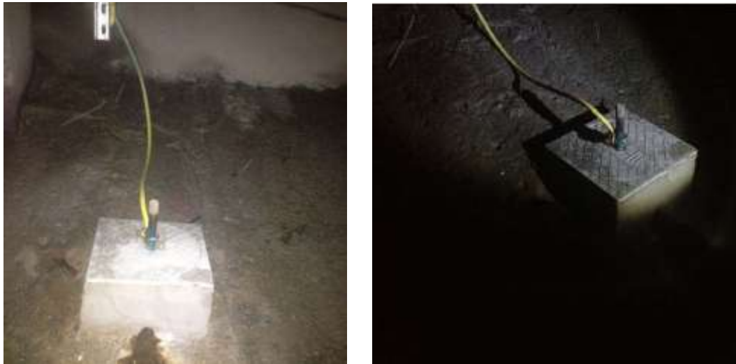
Foto 1.- Detalles de la primera pica de tierra existente bajo el andén de vía 1 en la estación de Kabiezes.
