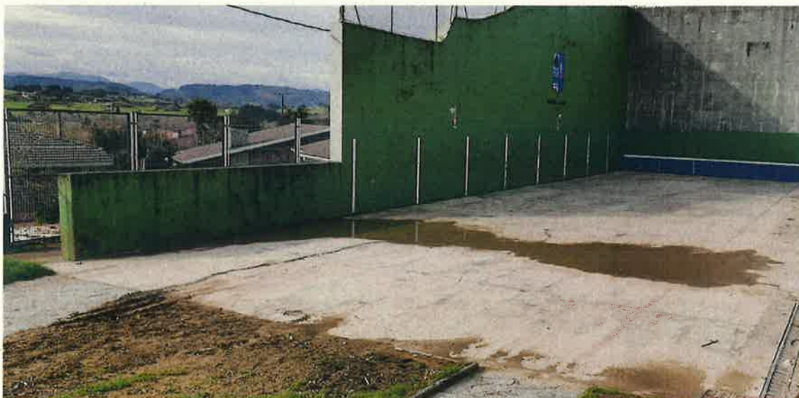
Fotografía de la cancha, se pueden observar las zonas encharcadas y las grietas aparecidas en la solera, principalmente en la parte final de la cancha.
