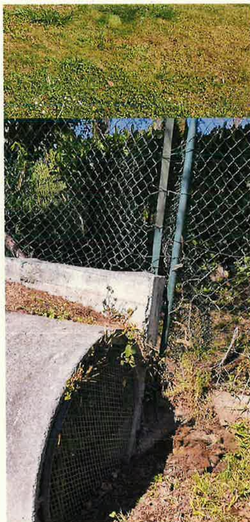
Fotografías de la zona verde junto al arroyo, donde conecta el colector de pluviales y por donde se localiza el daño en le colector de saneamiento.
