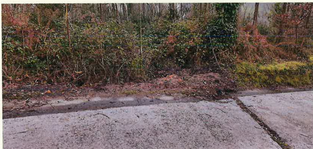
Fotografías de las cunetas y las zonas de corte para la evacuación del agua, donde se han producido deslizamientos del terreno dañando la cuneta.
