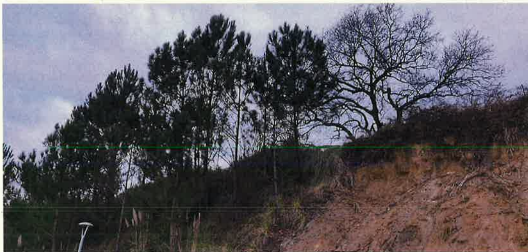
Fotografía de la zona superior del desprendimiento.
