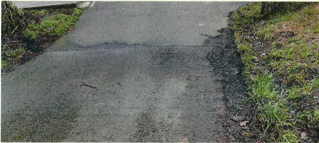
Fotografía de la zona del vial dañado.
