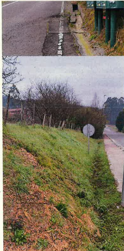
Fotografías de cunetas y conducciones de pluviales de la zona afectada.
