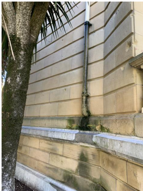
Fotos. Bajante con humedad
