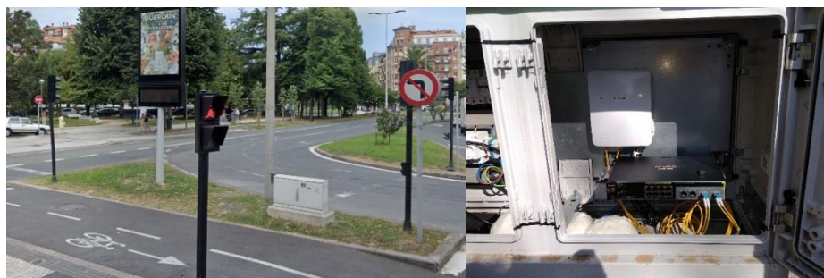
Armario Calle Parque
