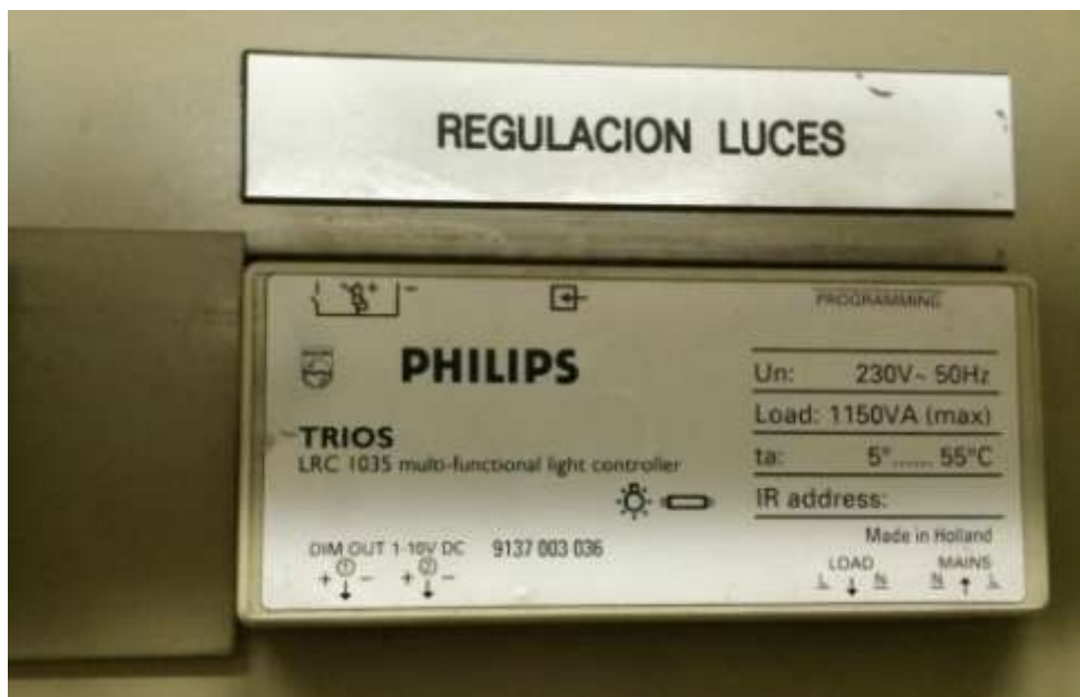
Equipo de Regulación dinámica de las luminarias directas de Andenes
