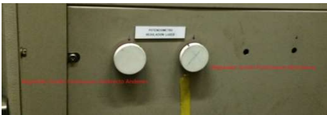
Equipo de Regulación de las luminarias Indirectas de Andenes y Mezzaninas.
