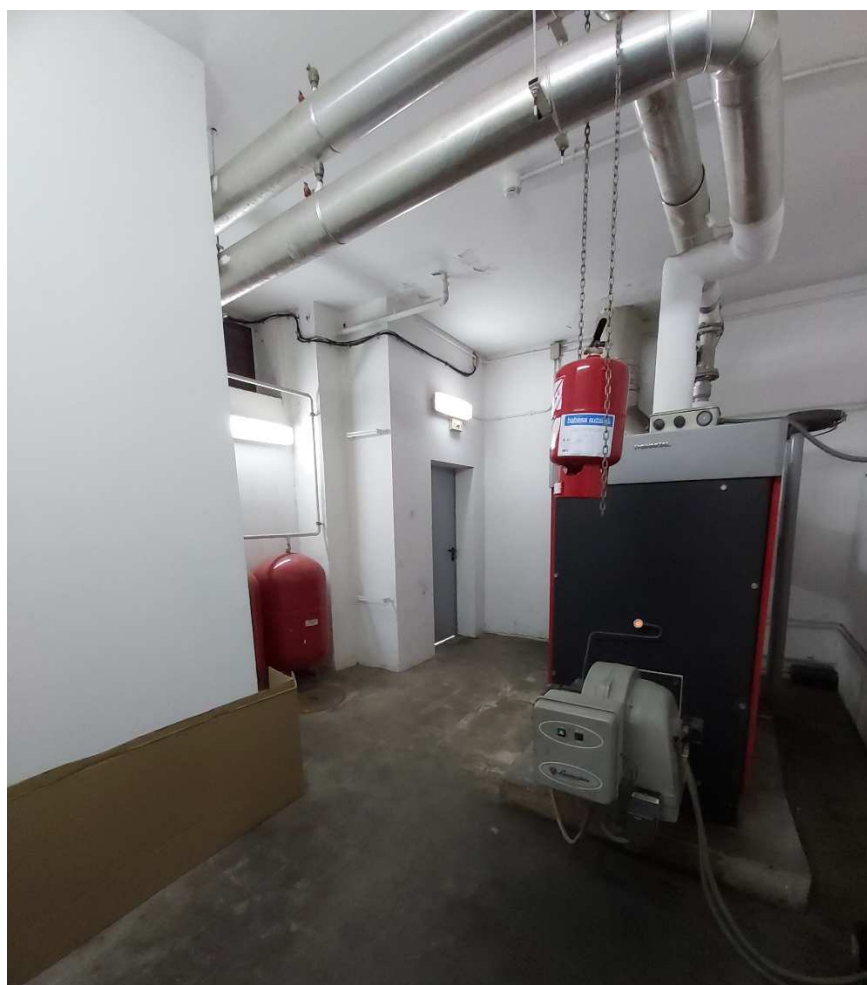
(Imagen de la Sala de Calderas)
