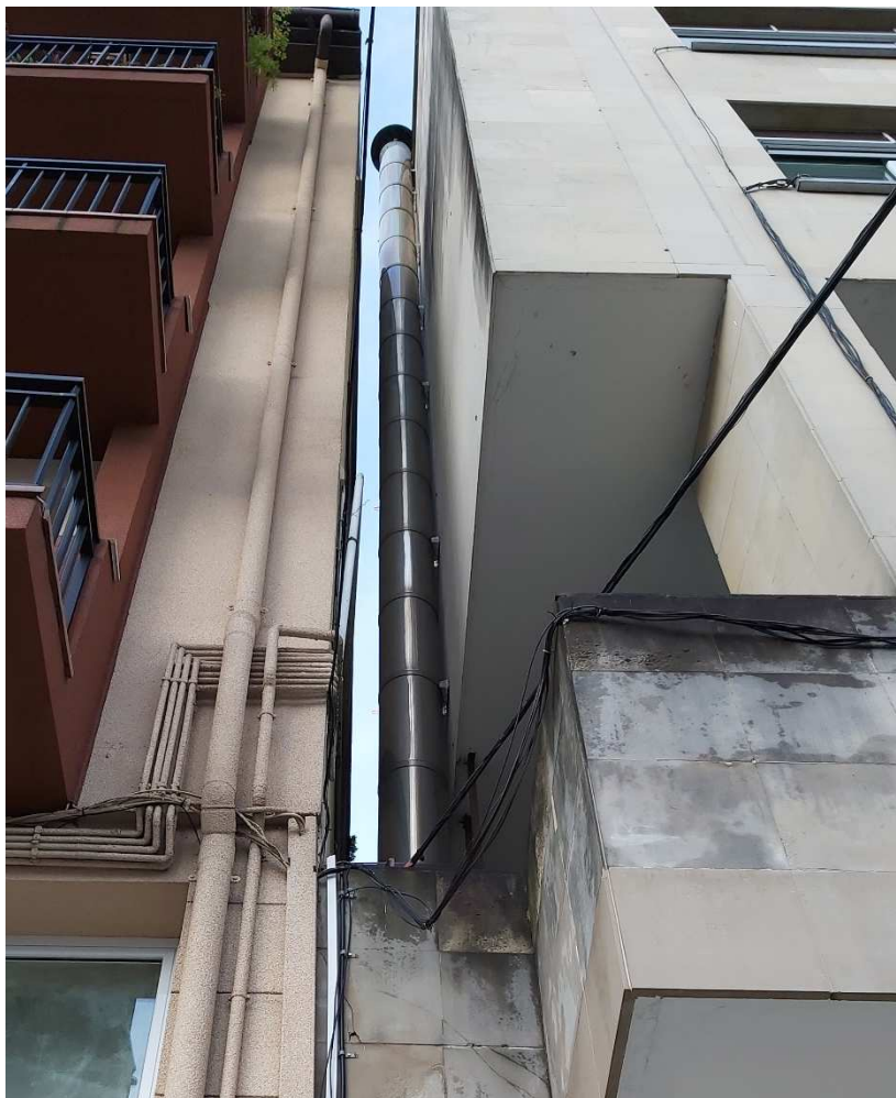
(Imagen de la chimenea de evacuación de humos de la caldera de Gasóleo-C)
