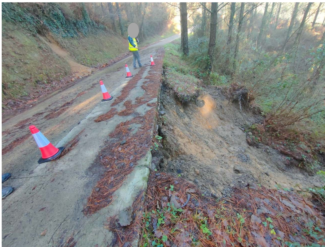
Vista del Desprendimiento 2
