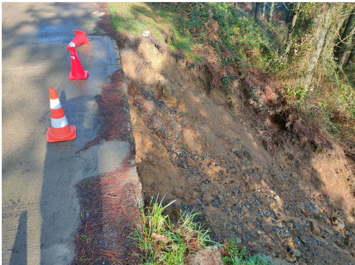
Vista del Desprendimiento 1
