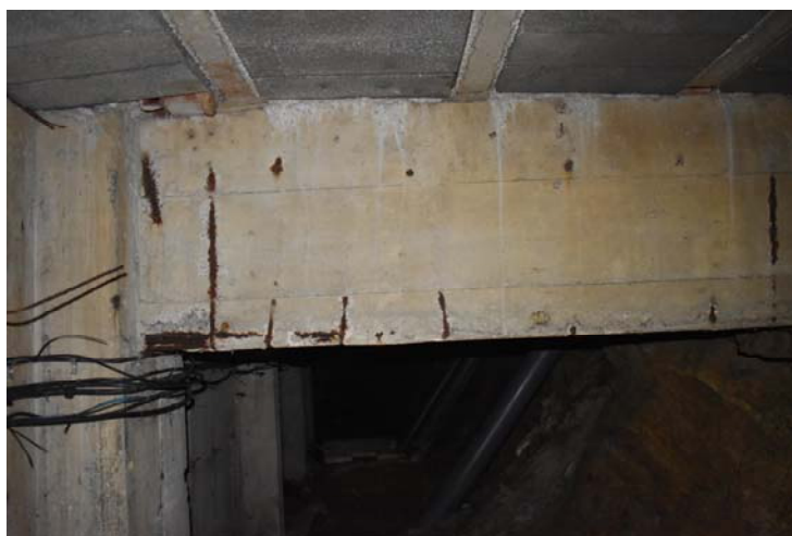
Imagen 6: Vista de una de las vigas que presentan patologías
