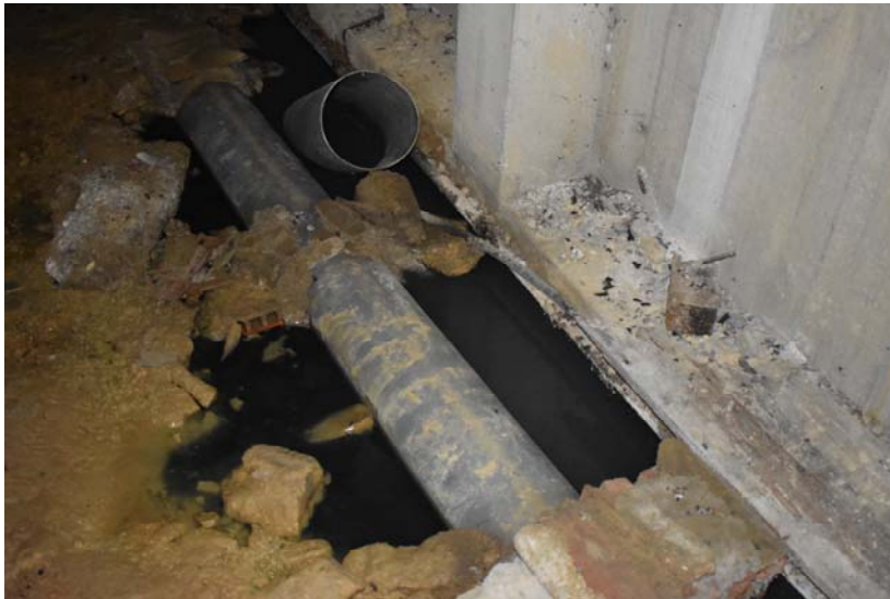
Imagen 2: Vista del colector con la fuga de aguas fecales
