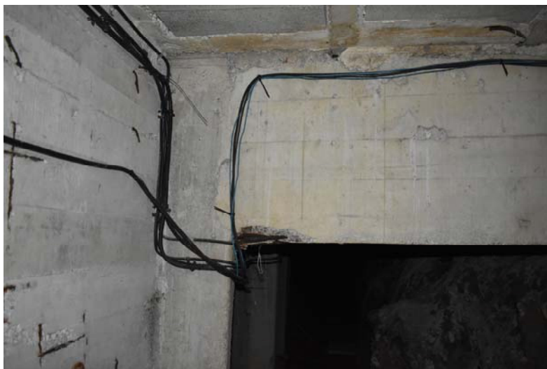
Imagen 4: Vista de las líneas eléctricas que atraviesan el sótano
