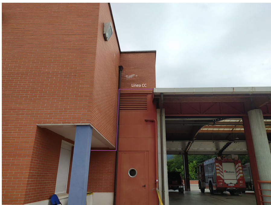
Canalización desde fachada exterior hasta interior del edificio
