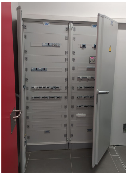
Cuadro General de Baja Tensión del edificio (CGBT)
