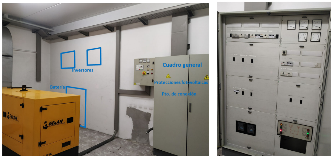
Ubicación inversores, batería y punto de conexión
