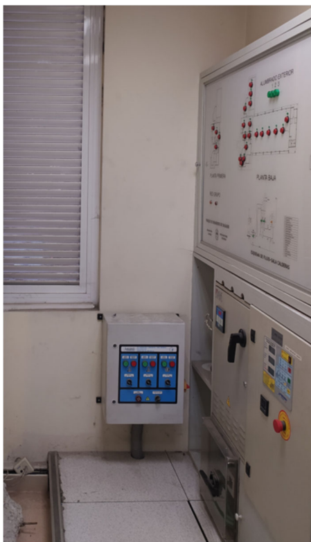
Cuadro General de Baja Tensión del edificio (CGBT)
