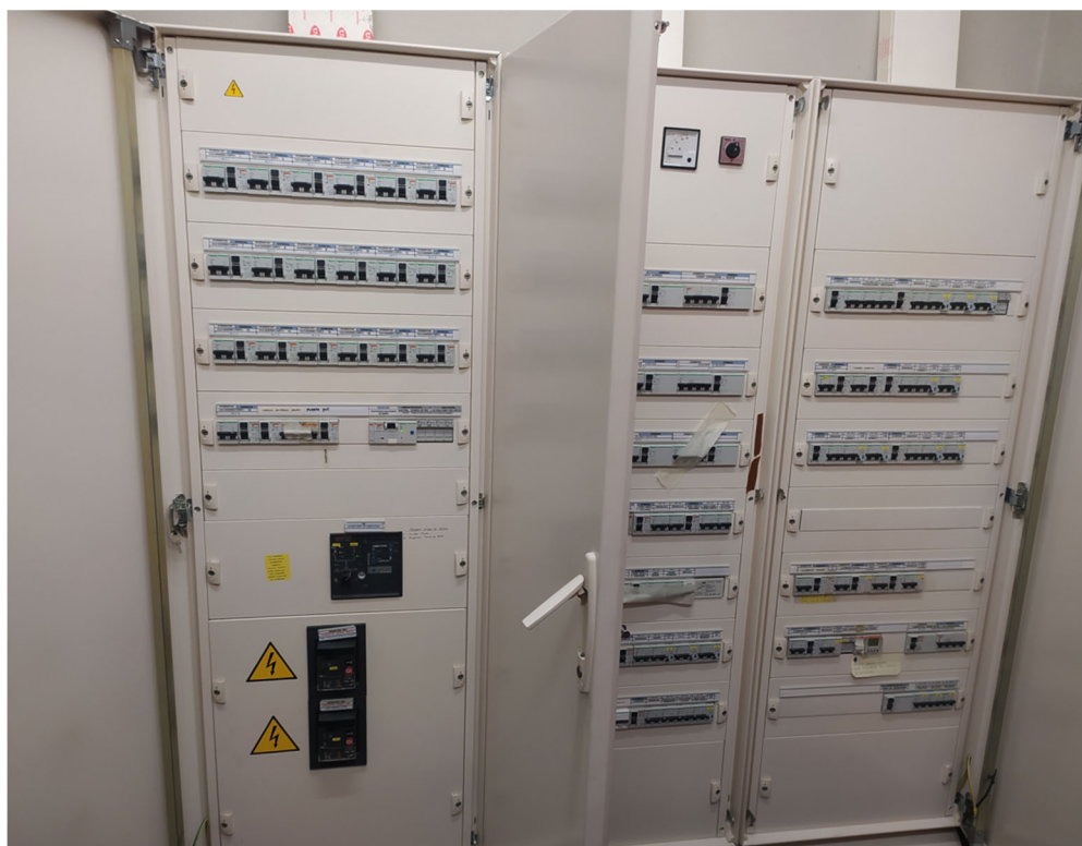
Cuadro General de Baja Tensión del edificio (CGBT)
