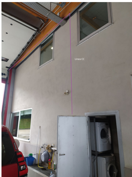
Canalización desde fachada exterior hasta interior del edificio
