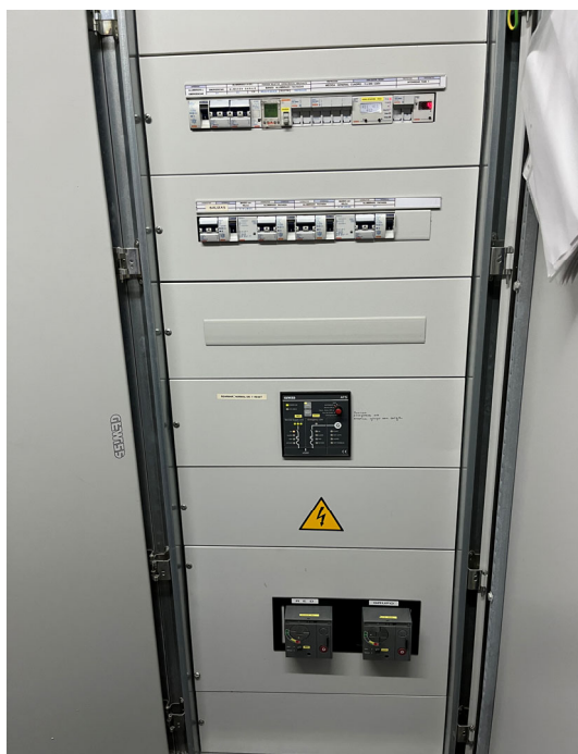
Cuadro General de Baja Tensión del edificio (CGBT)
