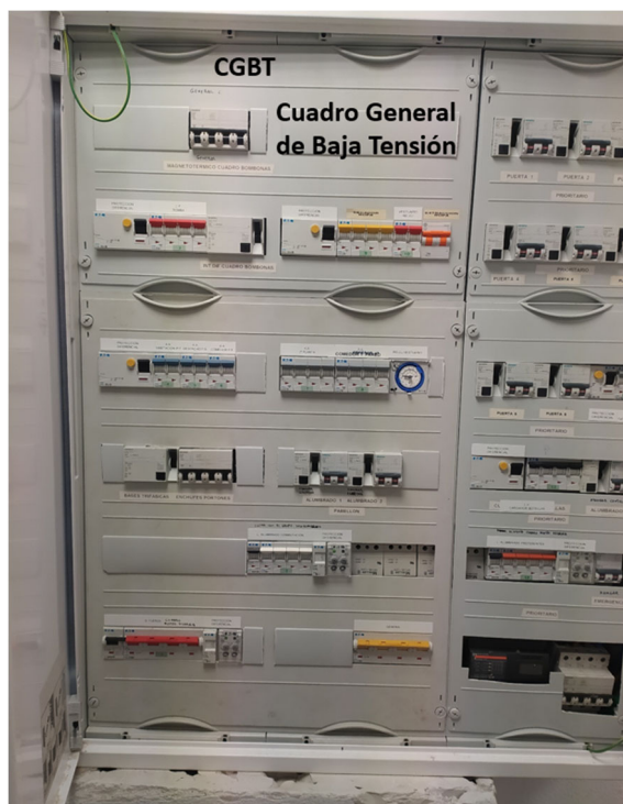
Cuarto eléctrico con el Cuadro General de Baja Tensión del edificio (CGBT)
