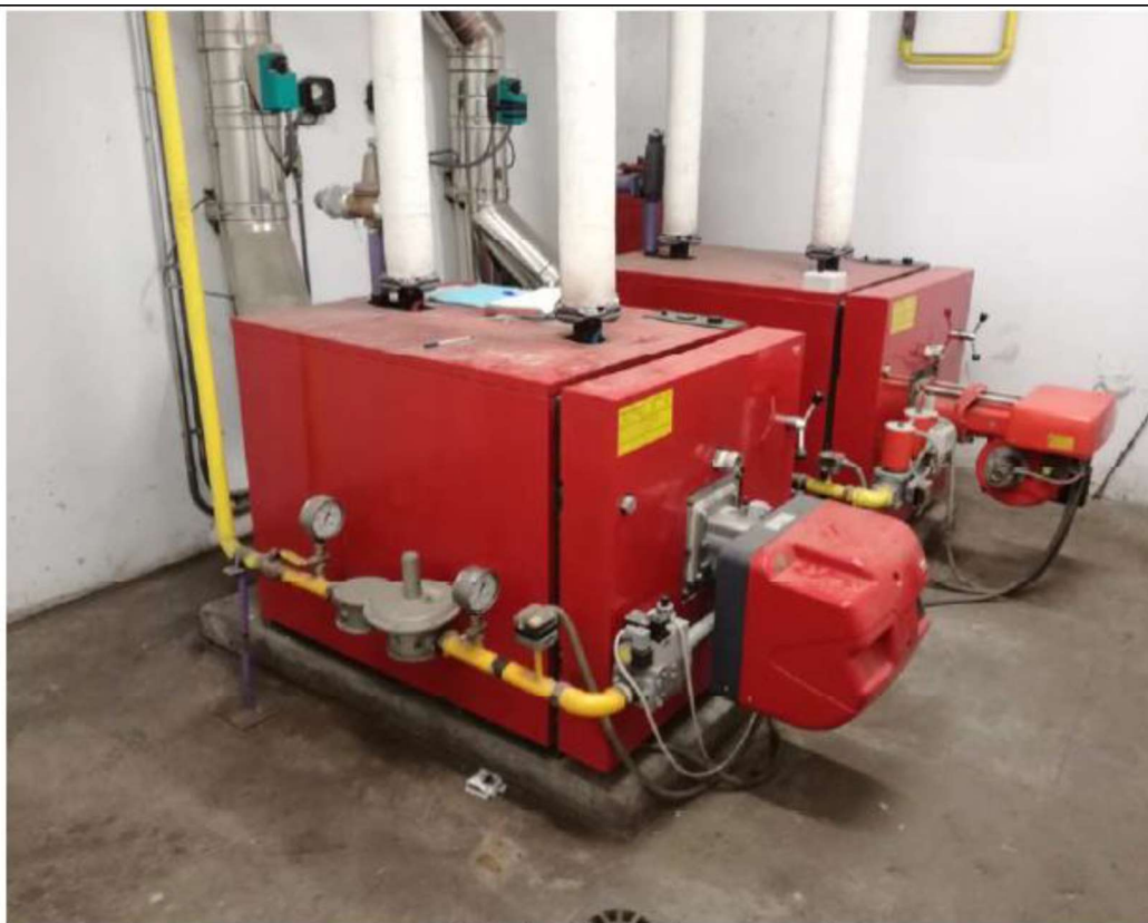
Detalle de las calderas de gas natural
