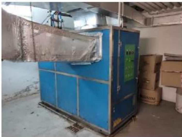
Bomba de Calor
