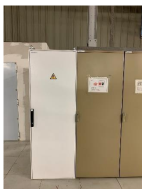
CP Fotovoltaica P6
