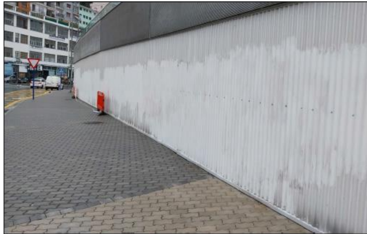
Marcas de pintadas borradas en la pared inferior.
