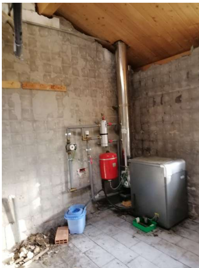
Caldera en planta primera para uso de local en planta baja.
