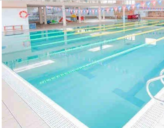
Líneas negras de marcaje de calles de nado decoloradas
