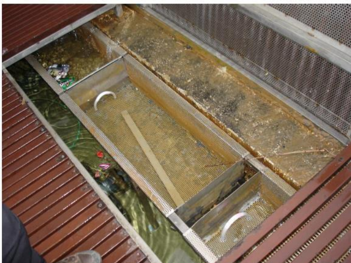
Vista filtro en cámara de bombeo
