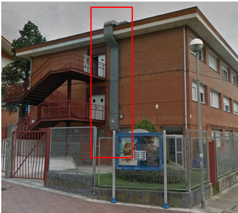
Figura 13: Derivación cableado a cuarto conserjería
