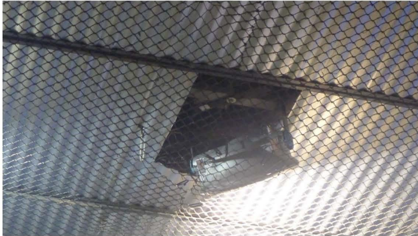
Detalle anclaje proyector a la estructura del techo
