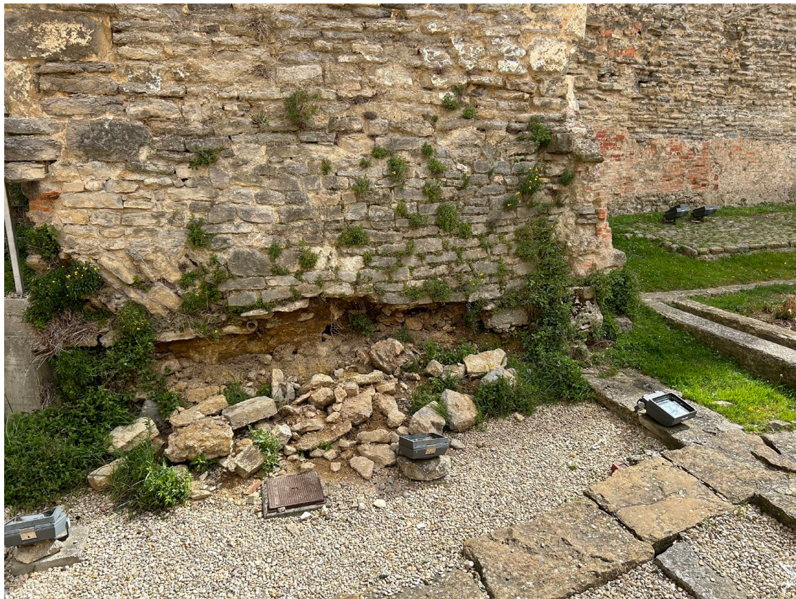
Fotografía 8: Desprendimiento de piedra en base de fachada Oeste del torreón.
