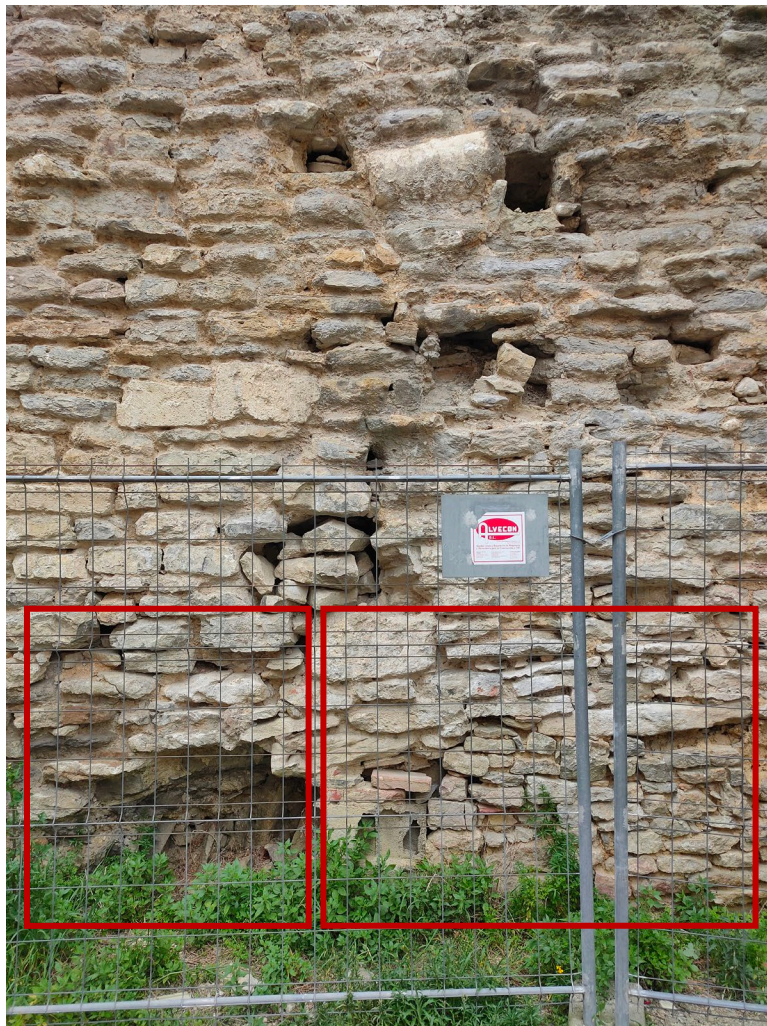
Fotografía 13: Izquierda, pérdida de mampostería en base de muralla original. Centro y derecha, relleno de piedra y materiales diversos ejecutados durante el s.XX. Se aprecian rellenos recientes en algunos huecos superiores donde se ha desprendido la piedra.
