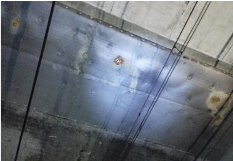
PK 20/626 - Clave - Lamina deteriorada en clave
