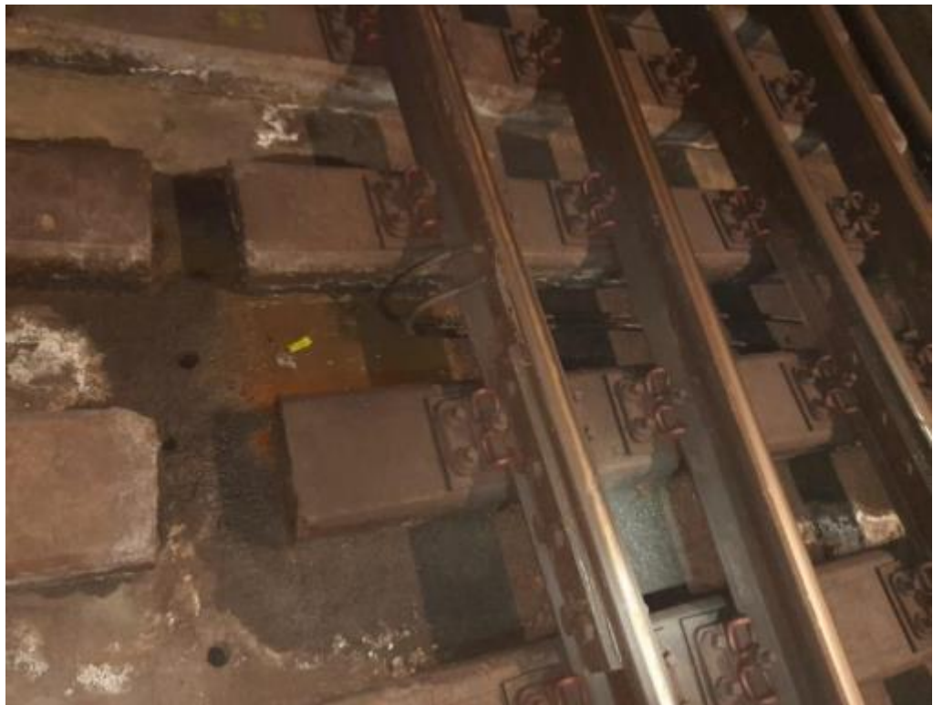
PK 06.883 - EV - Surgencia
