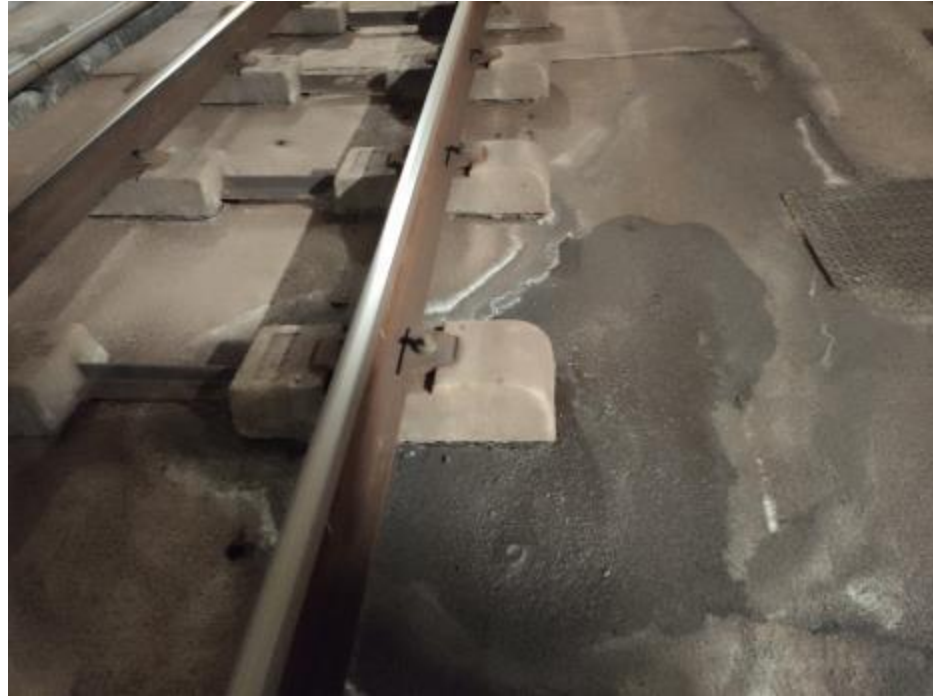
PK 20/017 - vía 1 y EV- surgencia
