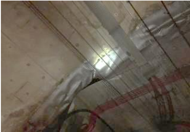
PK 05.370- Ambos hastiales- Abombamiento de lámina
