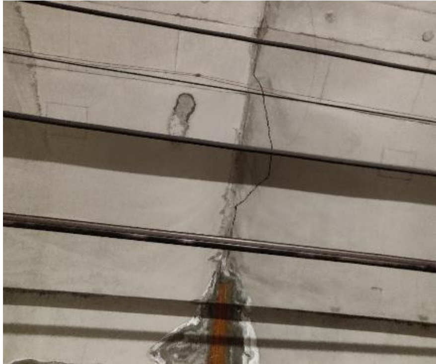
Pk 000/626 fisura en clave
