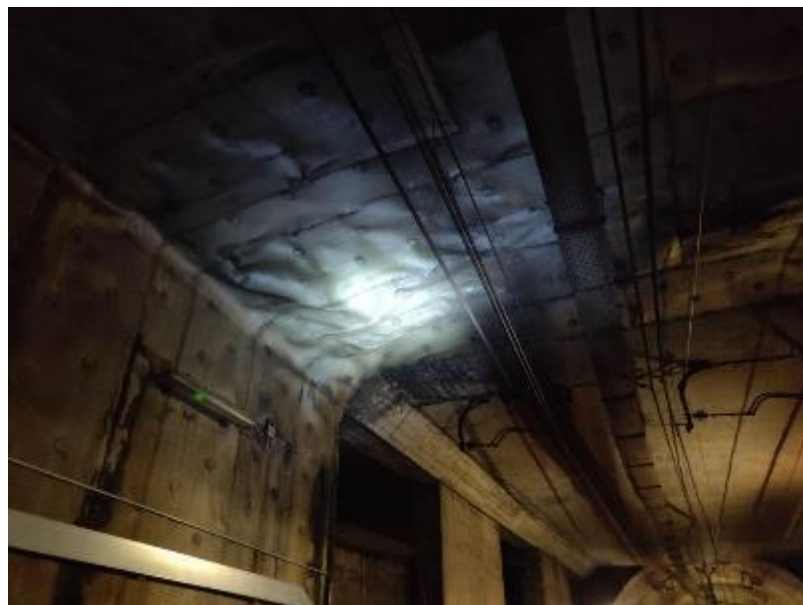
Abombamiento de Manta impermeabilizante
