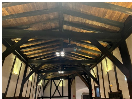
Fotografía: Proyector existente en sala de conferencias a sustituir
