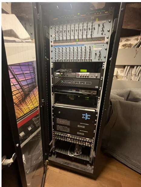
Fotografía: Rack existente
