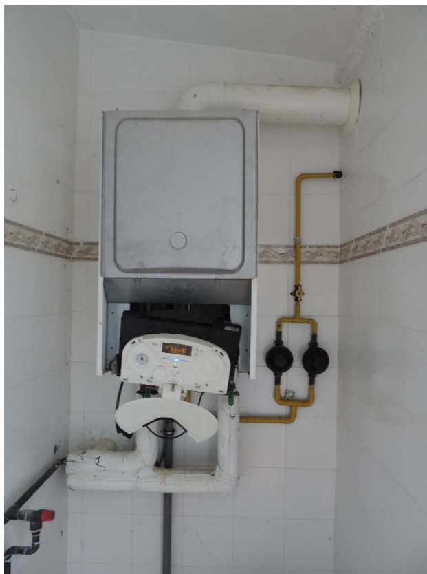
Estado deteriorado de caldera Ariston Premiun H65
