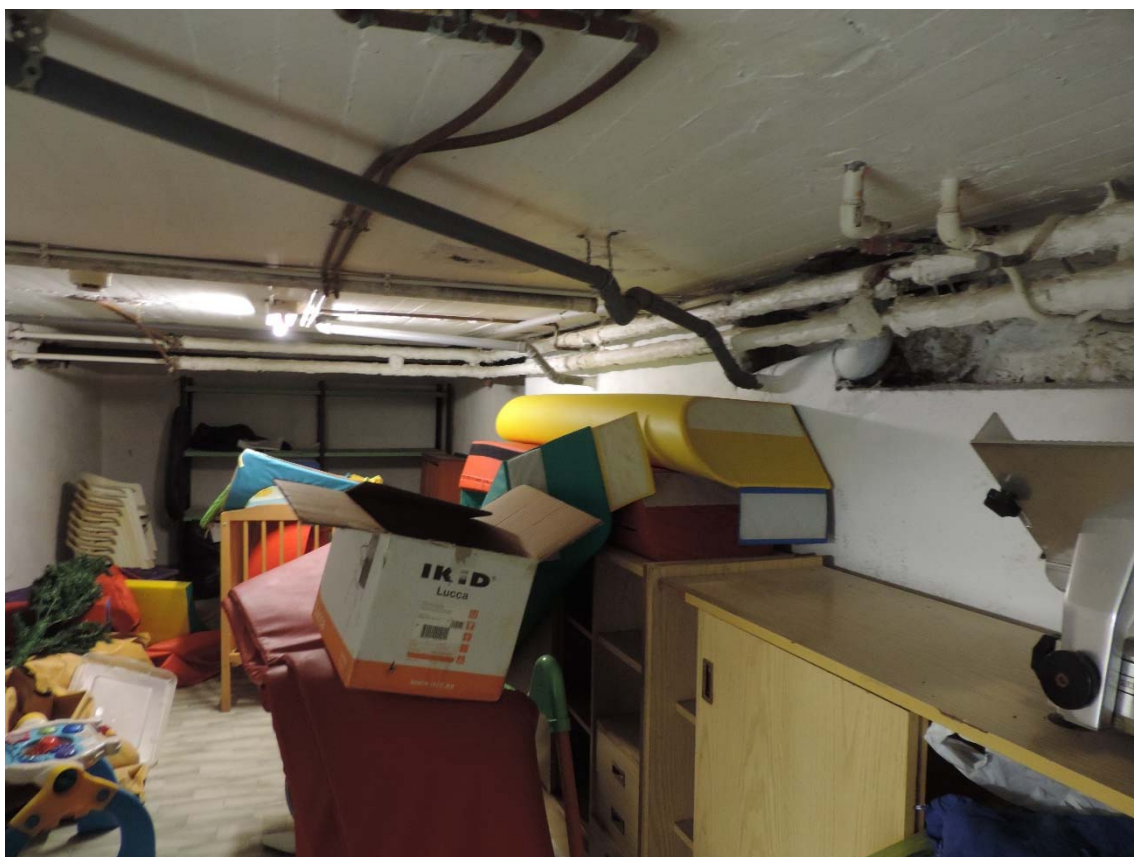
Conduitos de calefacción en techo de planta baja_almacen oeste
