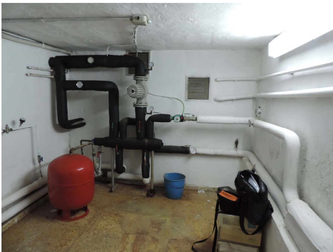
Vista general de sala de bombas de calefaccion
