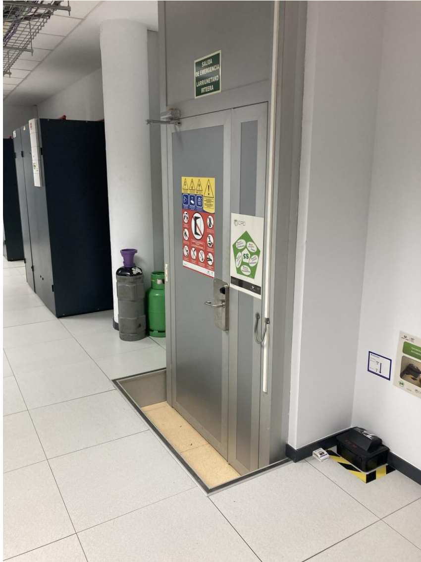
Puerta de entrada a la sala de máquinas (vista desde el interior donde se ve el escalón debido al suelo técnico)
